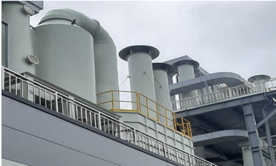
Hình 9. Hệ thống thu gom và xử lý khí thải của dây chuyền Top Coating
