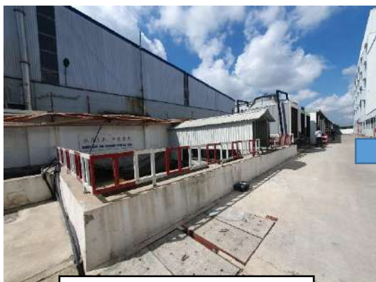
Bể chứa nước làm mát
