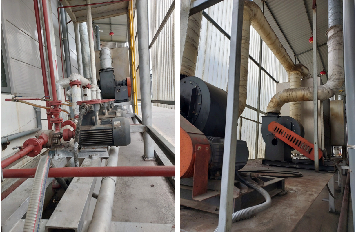
Hình 3.7. Hệ thống thu gom hơi Sn xưởng 22, 23, 25
