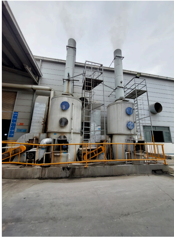
Hình 3.10. Hệ thống xử lý khí thải xưởng 29
