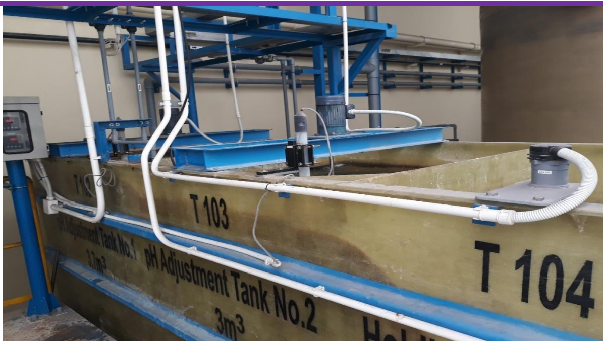
Hình 3.11. Hệ thống xử lý nước thải mạ công suất 300 m 3 /ngày đêm
