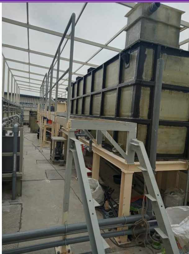
Hình 3. 13. Hệ thống xử lý nước thải nhiễm dầu công suất 150 m 3 /ngày đêm
