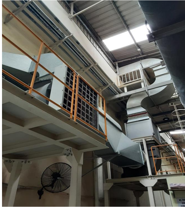
Hệ thống xử lý khí thải bằng than hoạt tính
