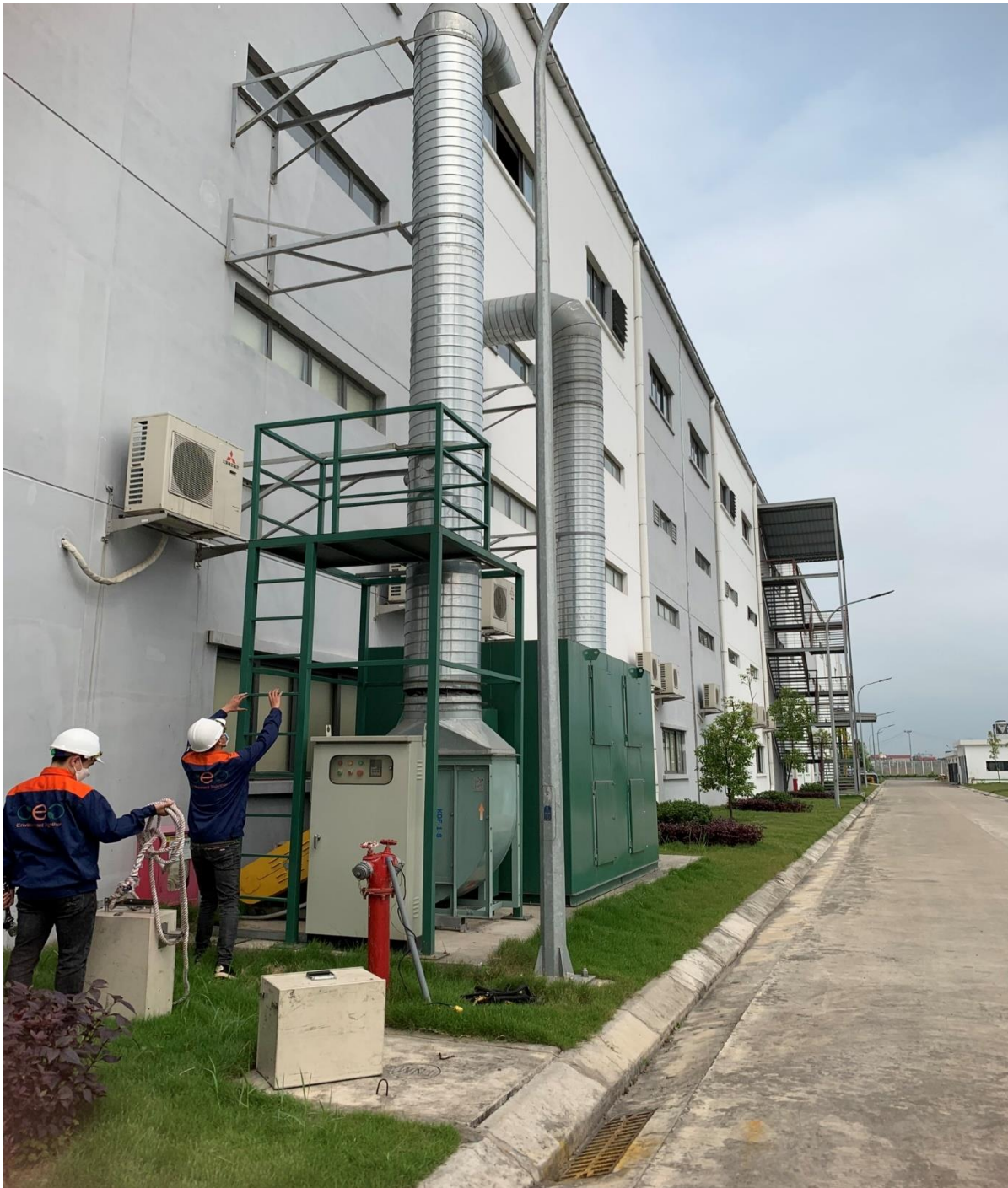
Hình 3.12. Hệ thống xử lý hơi hữu cơ công đoạn ép nhựa
