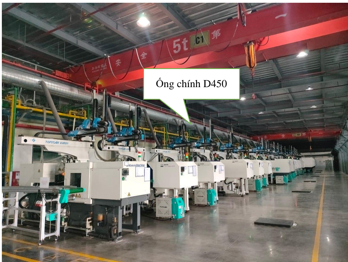
Hình 3.7. Hệ thống thu gom, xử lý hơi hữu cơ công đoạn ép nhựa (tầng 1)
