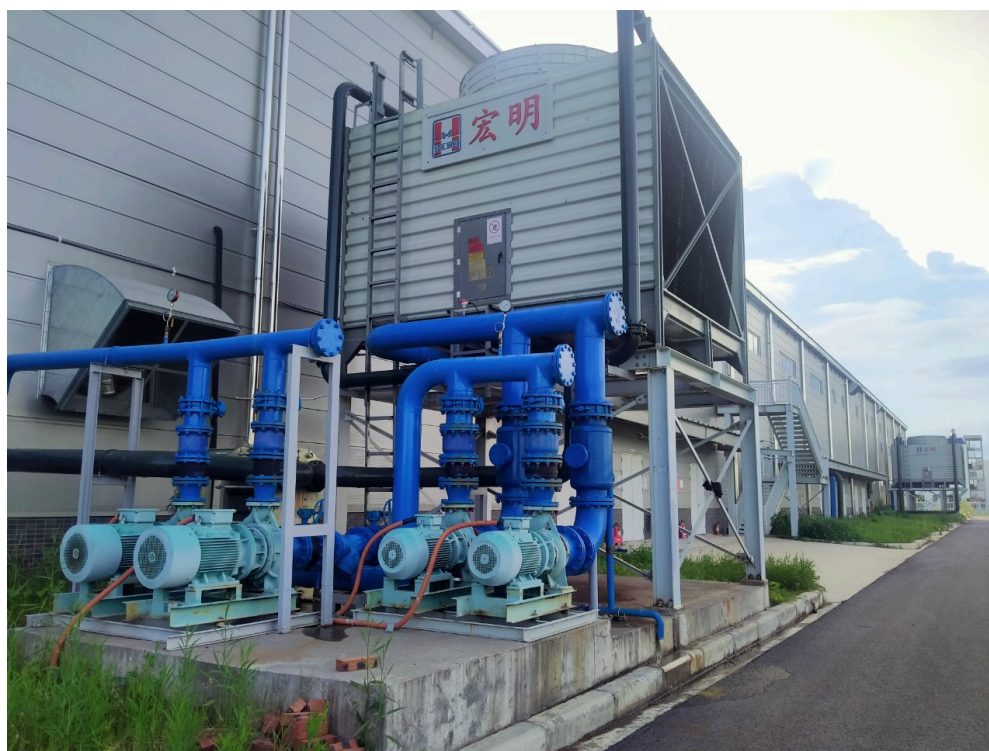
Hình 3.5. Hình ảnh tháp giải nhiệt của Nhà máy
