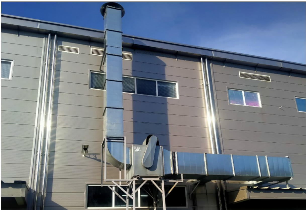
Hình 3.13. Ống thải hệ thống xử lý khí thải nhà bếp
