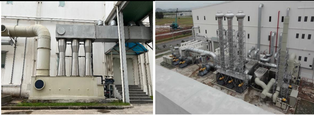
Hình 36. Hệ thống xử lý khí thải khu vực phun sơn cách điện – Nhà xưởng 2
