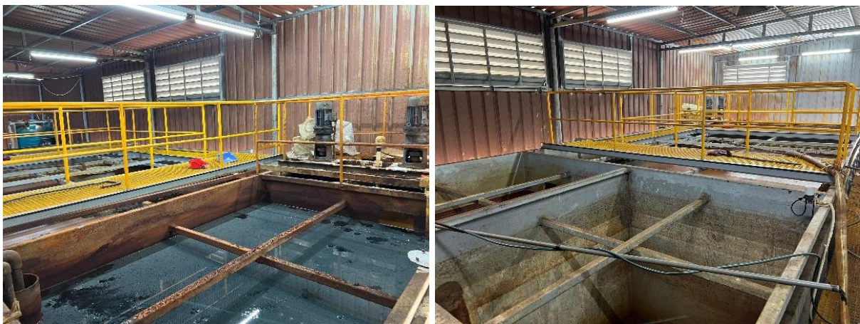
Hình 25. Hình ảnh hệ thống xử lý nước thải tổng hợp 400 m 3 /ngđ
