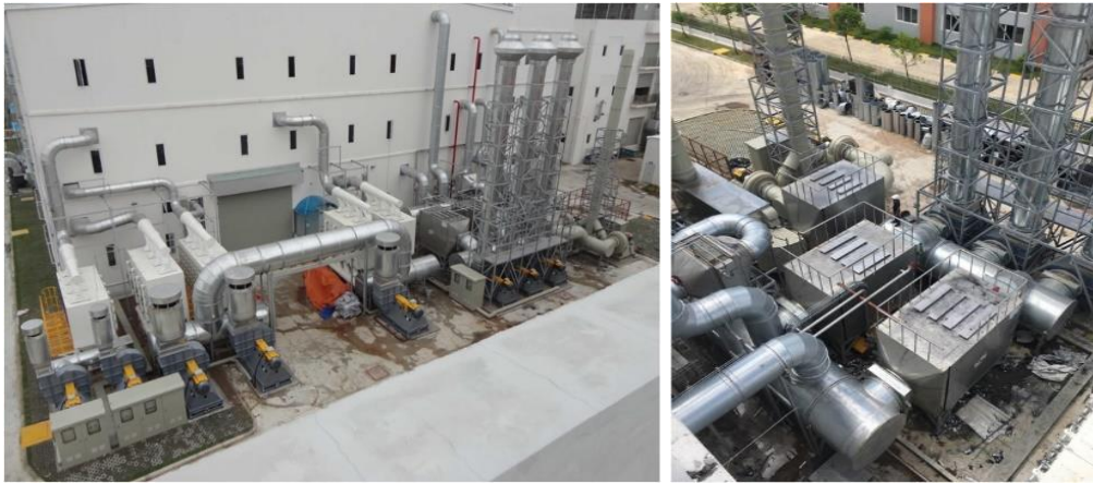
Hình 33. Hệ thống xử lý khí thải khu vực tráng bạc, sấy – Nhà xưởng 2
