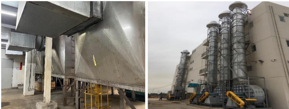
Hình 27. Hệ thống xử lý khí thải khu vực chằm keo, sấy, tráng bạc – Nhà xưởng 1
