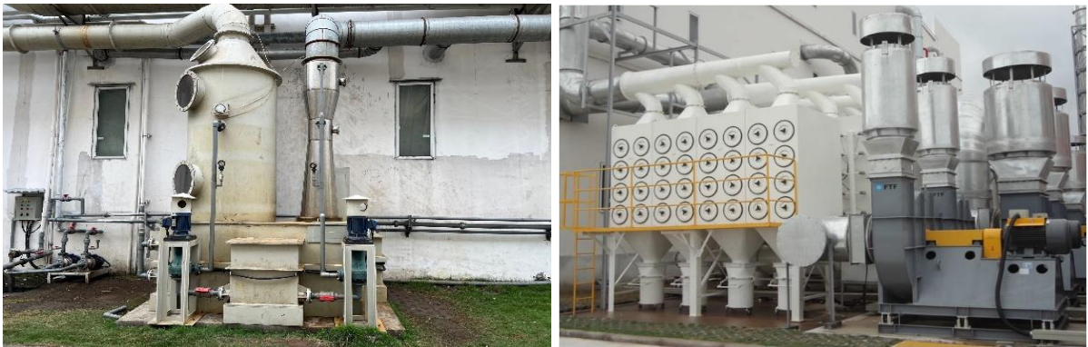
Hình 38. Hệ thống xử lý bụi khu vực trộn, mài dây chuyên sản xuất hạt cuộn cảm – Nhà xưởng 2
