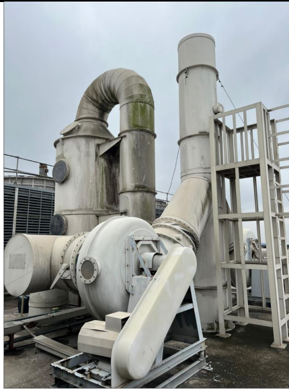
Hình 30. Hệ thống xử lý hơi axit khu vực mạ điện – Nhà xưởng 1
