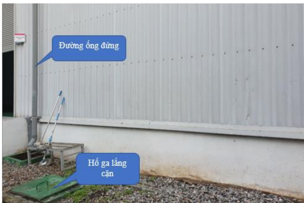
Hình 3.5. Hình ảnh hệ thống thu gom, thoát nước mưa tại nhà máy 3
