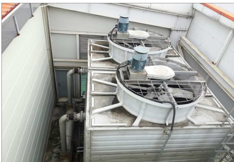
Hình 3.18. Tháp giải nhiệt nước làm mát bán thành phẩm linh kiện ô tô tại xưởng 3 Nhà máy 2
