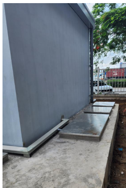
Hình 3.9. Hình ảnh HTXLNTSH số 01 công suất thiết kế 100 m 3 /ngày đêm
