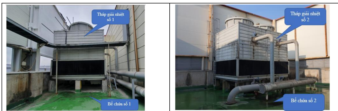
Hình 3.17. Hệ thống giải nhiệt nước làm mát bán thành phẩm linh kiện ô tô tại xưởng 1 nhà máy 2
