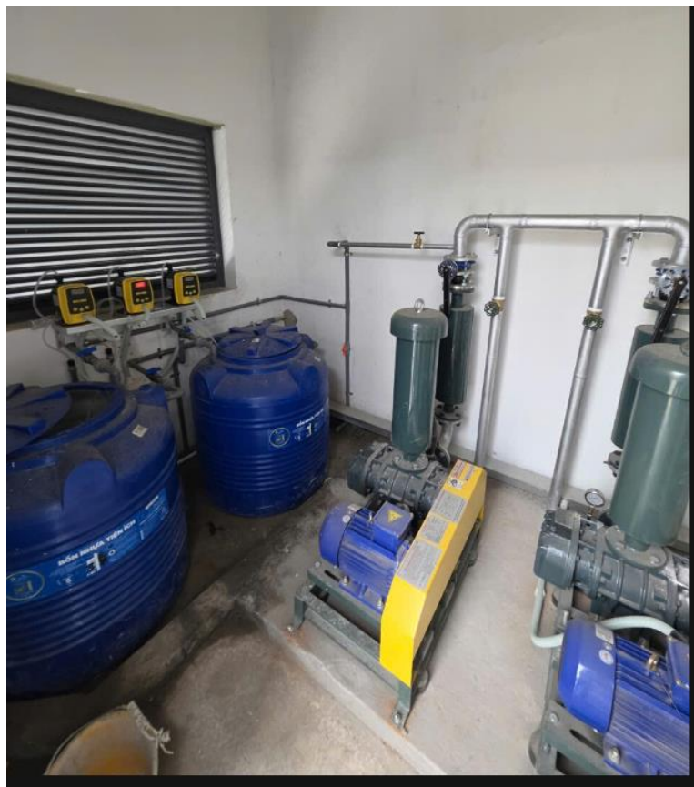
Hình 3.10. Hình ảnh HTXLNTSH số 02 công suất thiết kế 40 m 3 /ngày đêm
