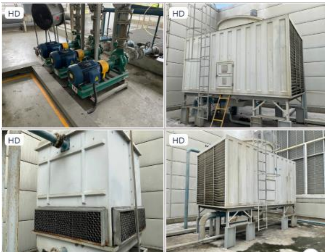
Hình 3.16. Hệ thống giải nhiệt nước làm mát bán thành phẩm xốp Nhà máy 1
