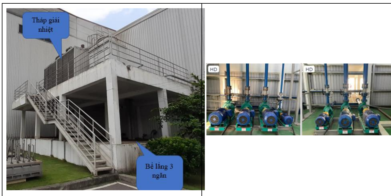
Hình 3.19. Hệ thống giải nhiệt nước làm mát bán thành phẩm xốp tại Nhà máy 3
