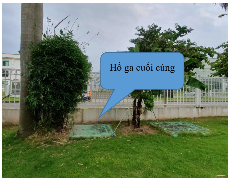
Hình 3.12. Công trình xử lý, thoát nước thải sinh hoạt tại Nhà máy 3
