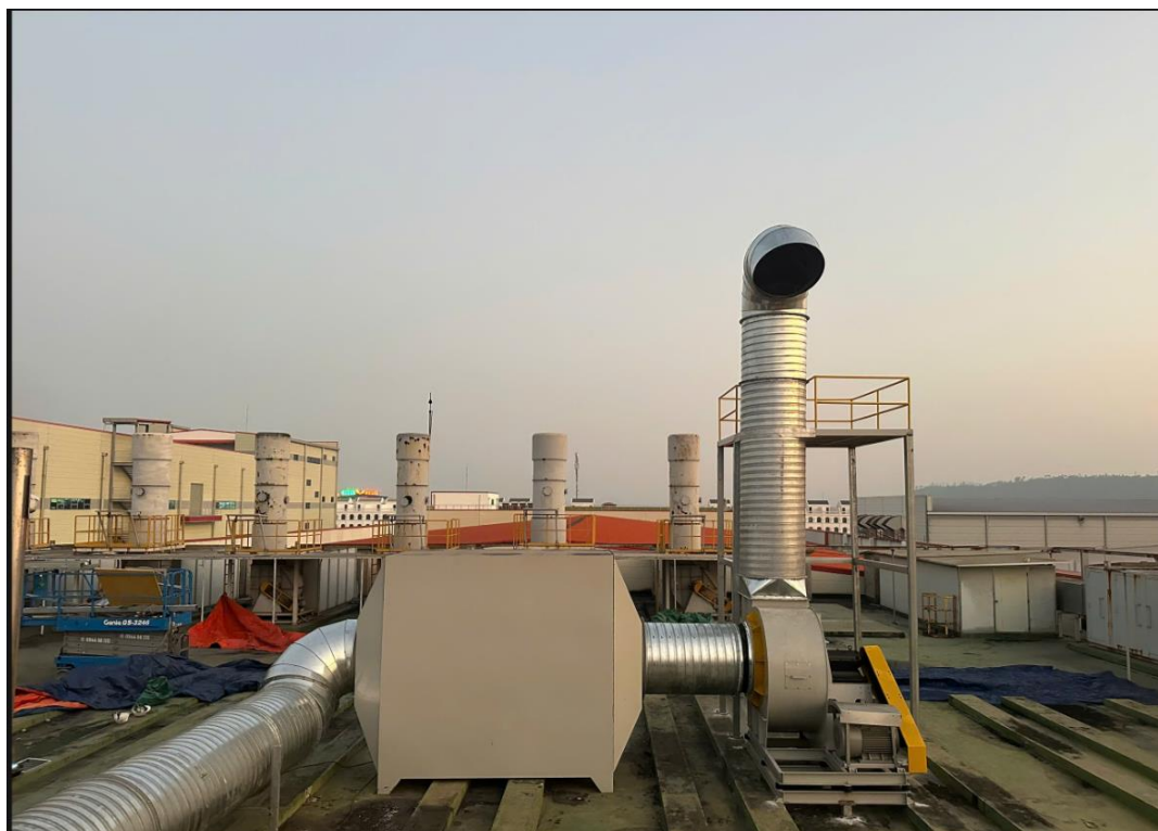
Hình 3.24. Hình ảnh HTXLKT từ 70 máy ép phun nhựa xưởng 01 (nhà máy 2)
