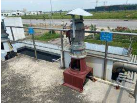
Bể keo tụ - tạo bông
