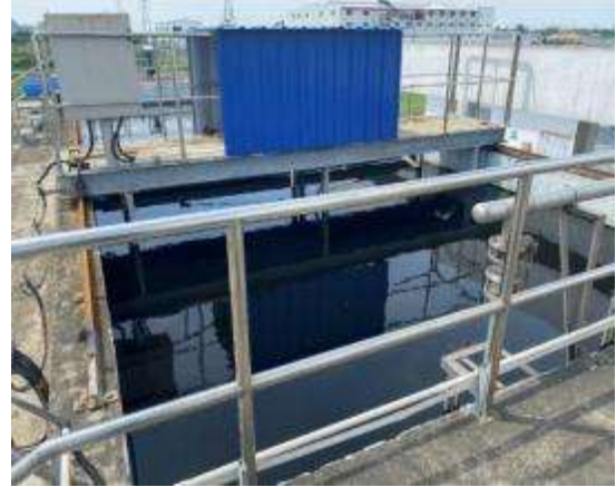
Bể lắng bùn hóa lý (lắng 1)
