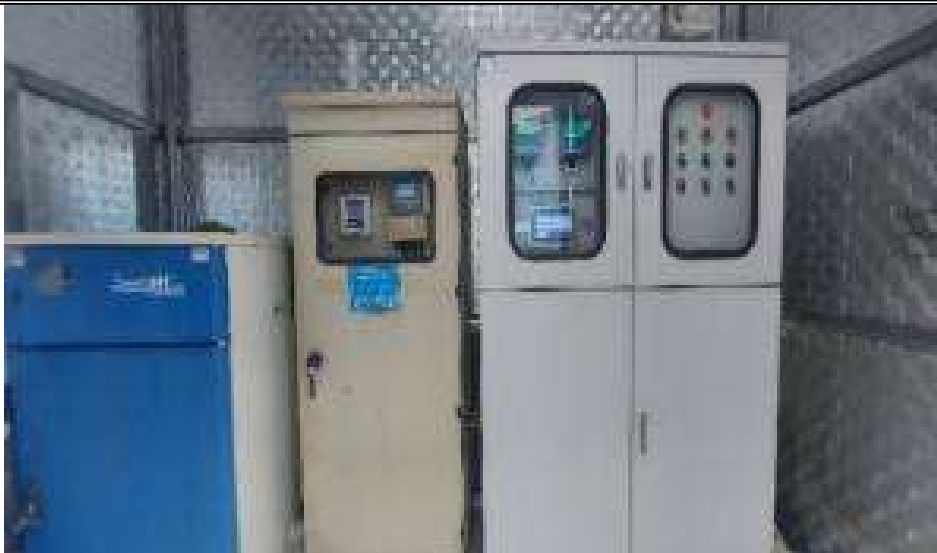
Hình 3.9. Hệ thống quan tắc tự động, liên tục của trạm XLNT của KCN An Dương
