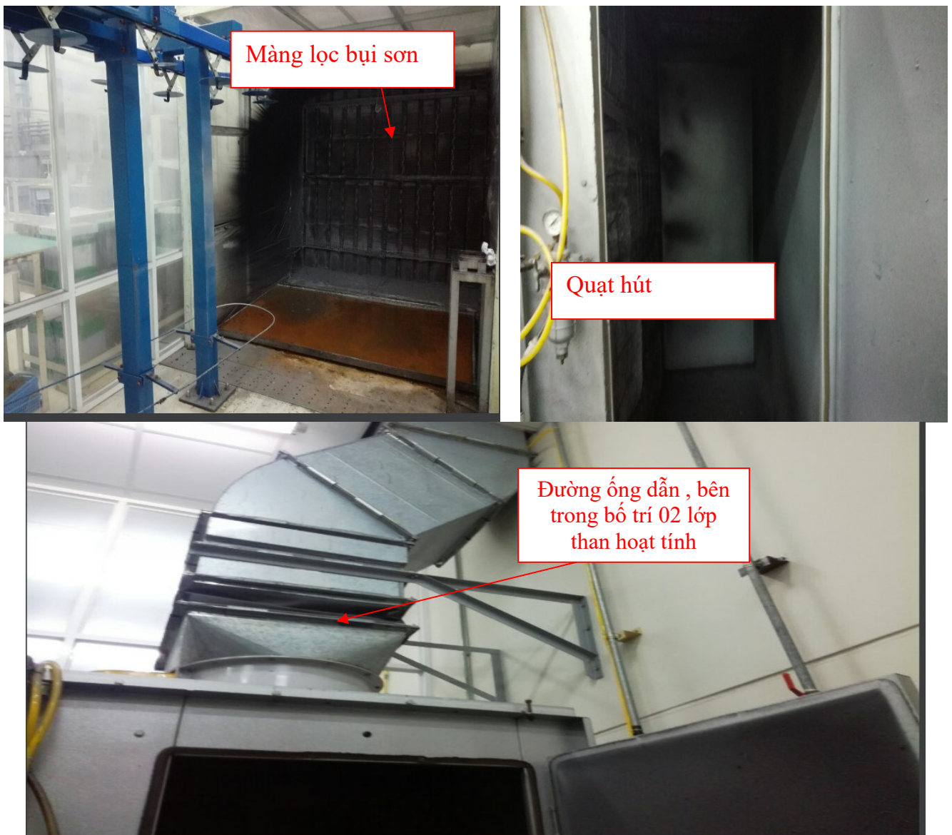
Hình 3.11. Hệ thống hút bụi buồng phun sơn tại xưởng 1
