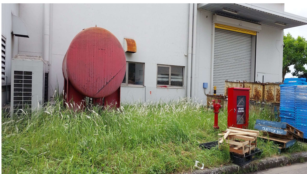
Hình 3.19. Hệ thống PCCC của Công ty
