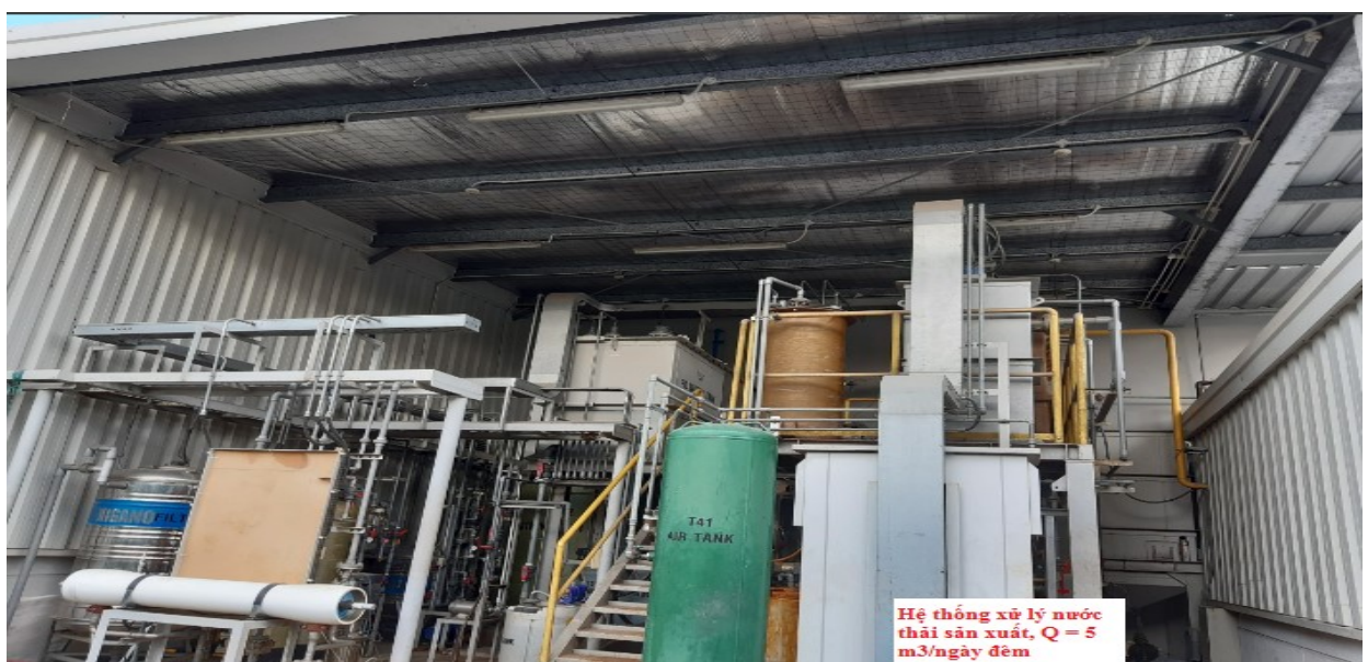
Hình 3.6. Hệ thống xử lý nước thải sản xuất, công suất 5 m 3 /ngày đêm
