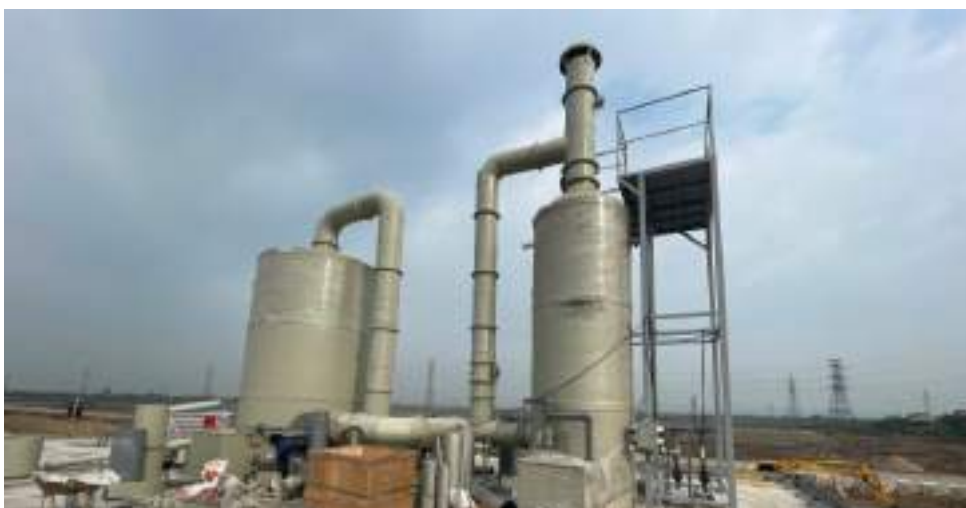
Hình 3. 6. Hệ thống xử lý khí thải từ HTXL nước thải
