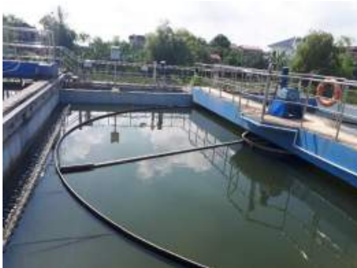
Bể lắng sinh học
