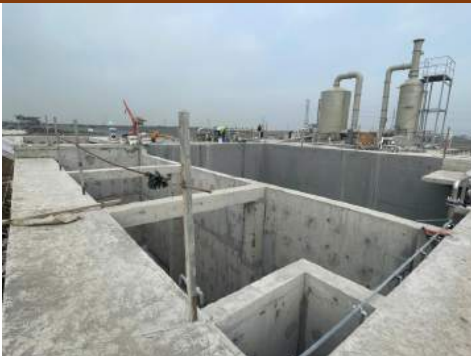
Hình 3. 5. Các bể xử lý nước thải
