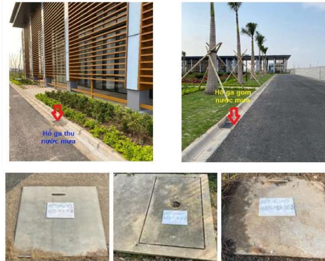
Hình 3. 3. Một số hình ảnh công trình thu thoát nước mưa hiện tại của Cơ sở
