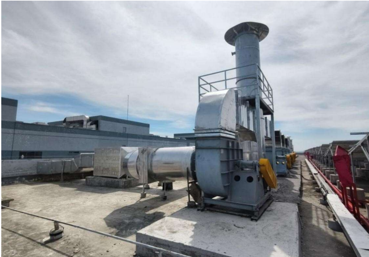
Hình 3. 24. Hệ thống xử lý khí thải tầng 1 xưởng F2 (HT21)
