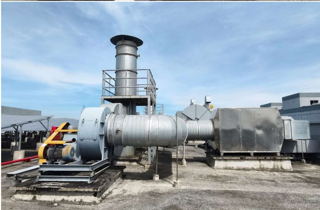
Hình 3. 25. Hệ thống xử lý khí thải tầng 2 xưởng F2 (HT04)
