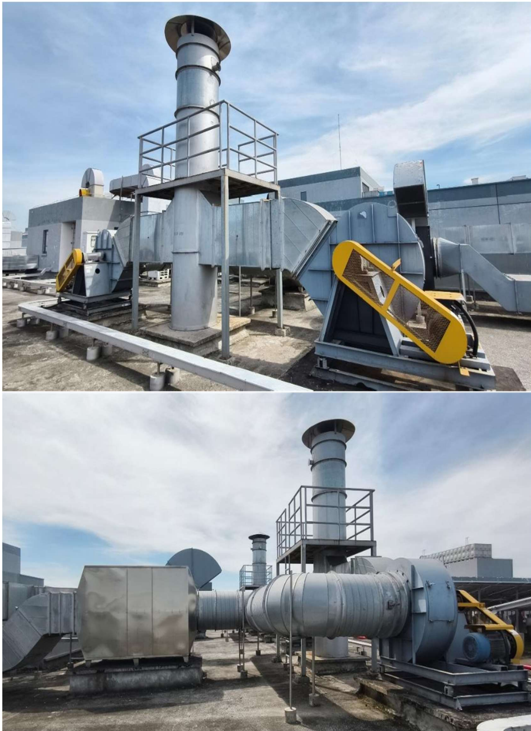
Hình 3. 26. Hệ thống xử lý khí thải tầng 3, xưởng F2 (HT03).
