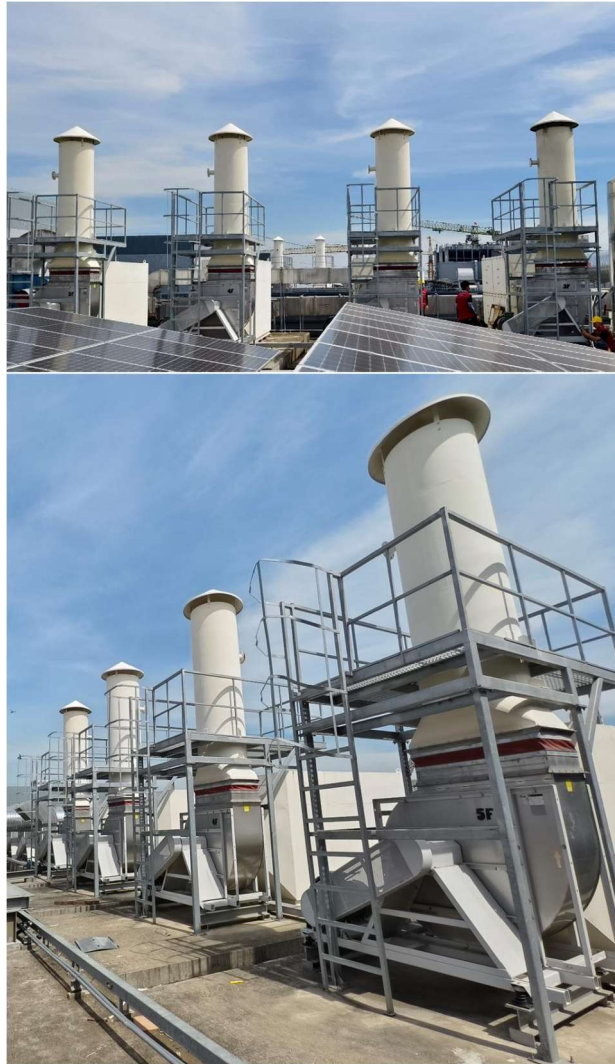
Hình 3. 34. Hình ảnh 08 hệ thống xử lý khí thải (công suất 30.000 m 3 /giờ/hệ thống) tầng 3, 4, 5 - xưởng F4 (HT05-HT12)
