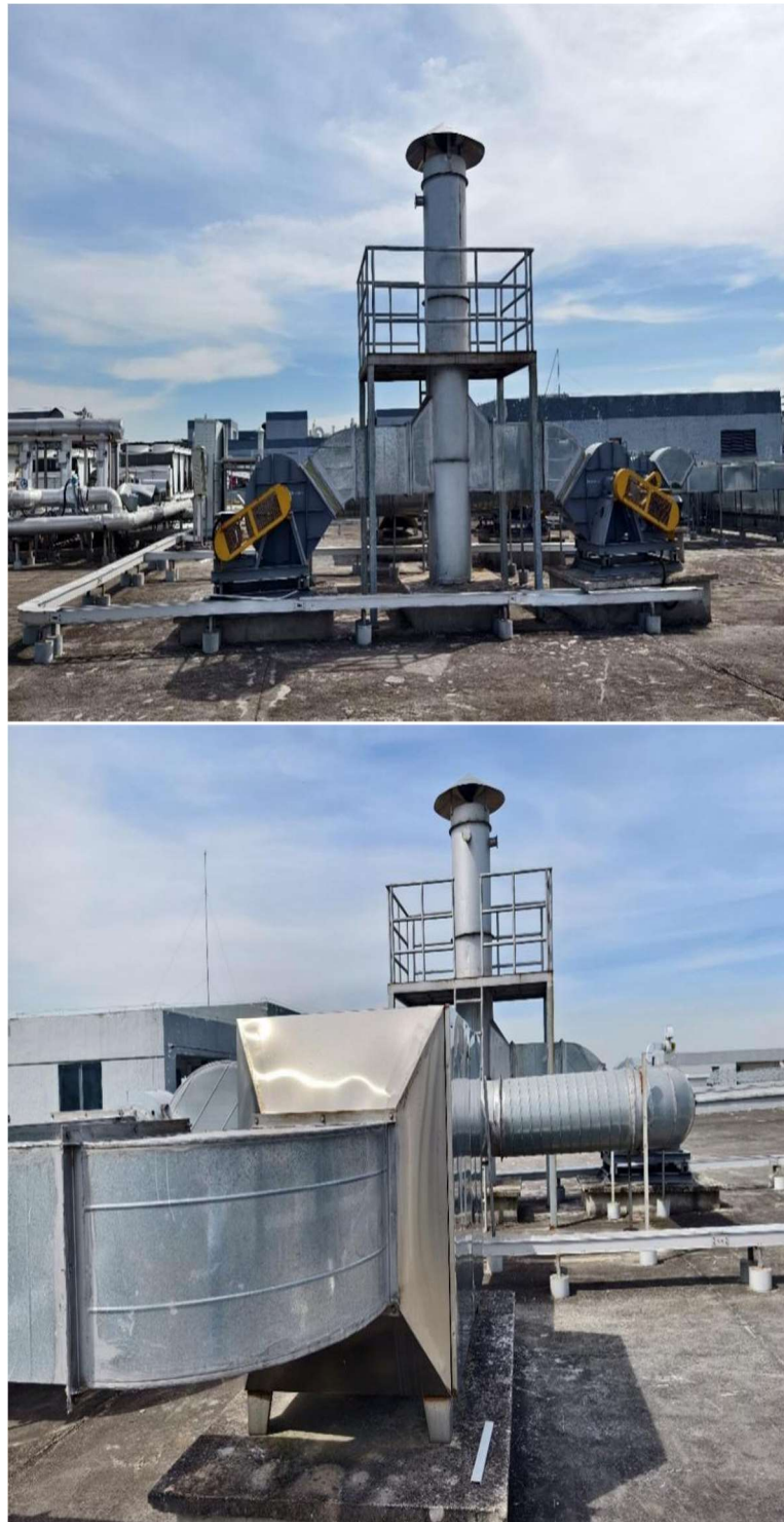
Hình 3. 23. Hệ thống xử lý khí thải nhà KD1 (HT02)
