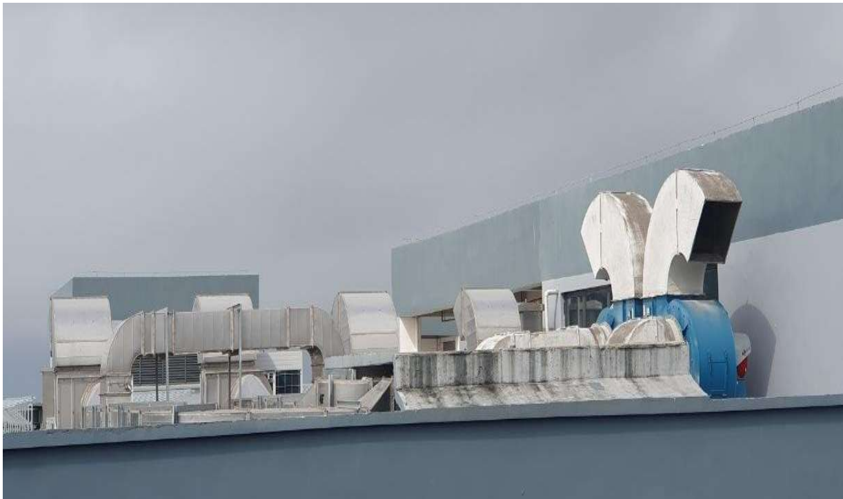
Hình 3. 37. Hình ảnh hệ thống thông gió F1-F5
