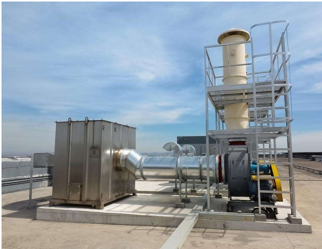
Hình 3. 27. Hệ thống xử lý khí thải xưởng F3 (HT24).
