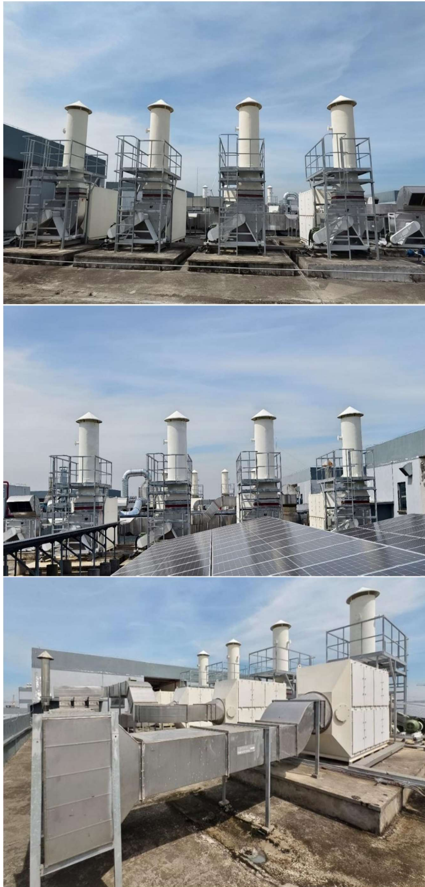
Hình 3. 36. Hình ảnh 08 hệ thống xử lý khí thải xưởng F5 (HT13-HT20)
