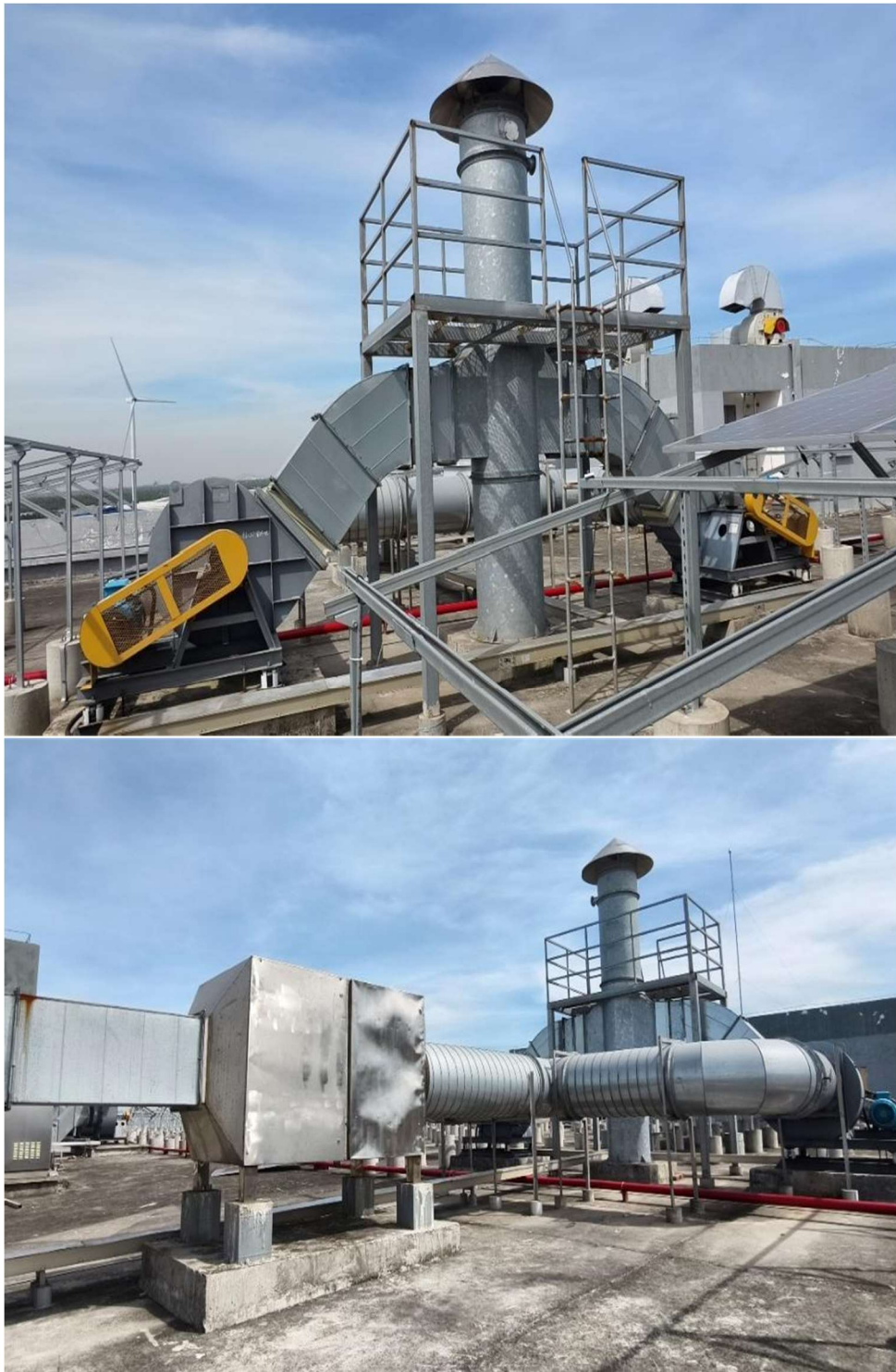
Hình 3. 22. Hệ thống xử lý khí thải xưởng F1 (HT01).
