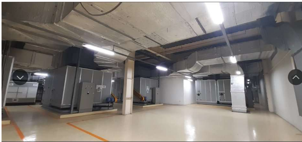
Hình 3.36. Hình ảnh hệ thống cấp khí tươi cho chuyển sơn tại địa điểm 02
