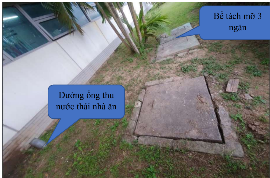
Hình 3.7. Hình ảnh bể tách mỡ tại địa điểm 02
