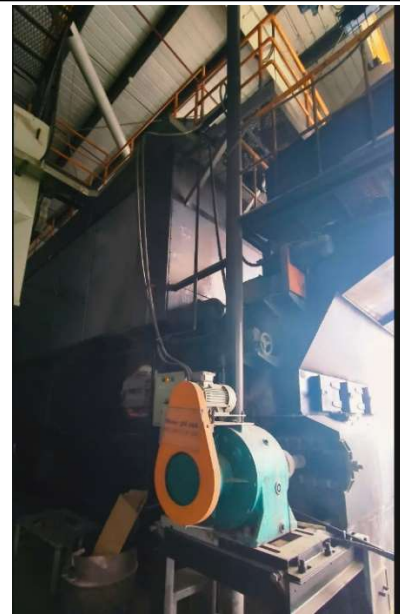
Nồi hơi sử dụng nhiên liệu sinh khối (công suất 10 tấn/giờ)
