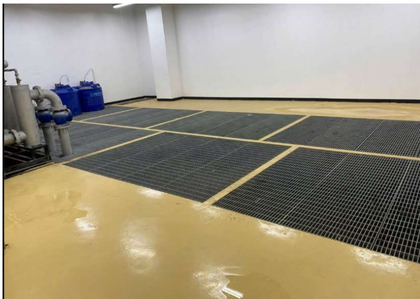
Hình 3.20. Hình ảnh bể 7 ngăn bên trong xưởng 04 tại địa điểm 02
