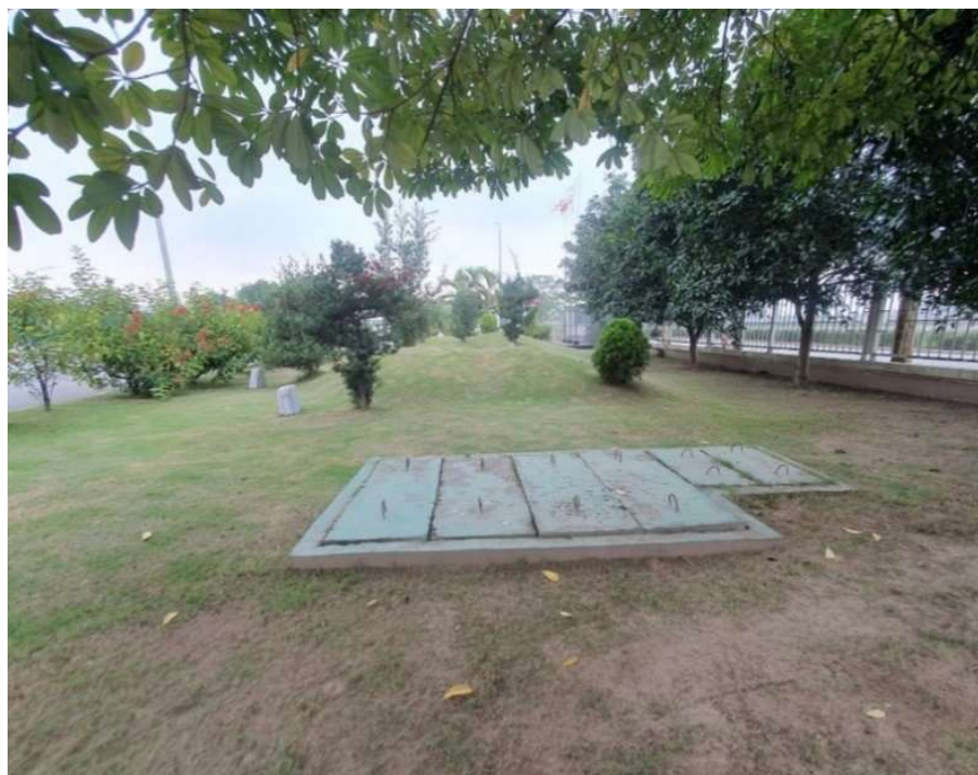
Hình 3.11. Hình ảnh hồ ga đầu nối nước thải tại địa điểm 02 (hồ bơm)
