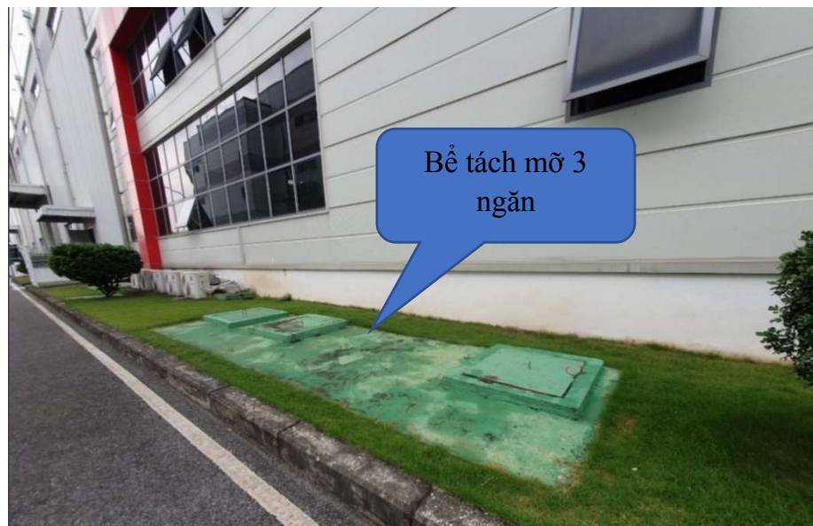
Hình 3.13. Hình ảnh bể tách mỡ tại địa điểm 03
