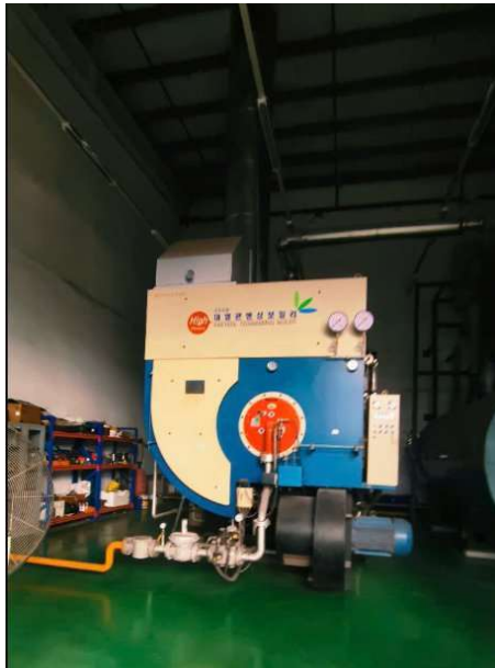
Nồi hơi sử dụng gas LPG
