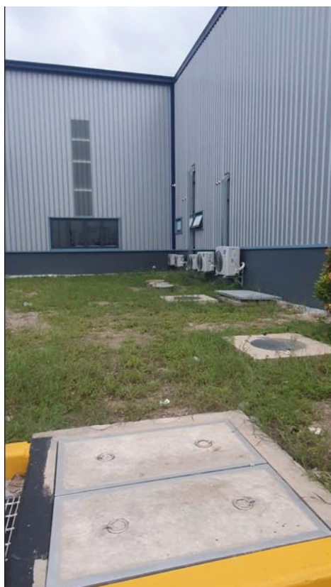
Hình 3.2. Hình ảnh bể tự hoại 3 ngăn, hố ga đầu nối nước thải sinh hoạt của dự án
