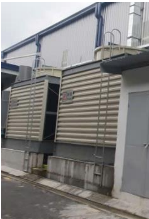
Hình 3.6. Hình ảnh tháp giải nhiệt của dự án
