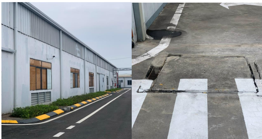
Hình ảnh ống thoát nước mưa mái và hố thăm thoát nước mặt tại cơ sở
