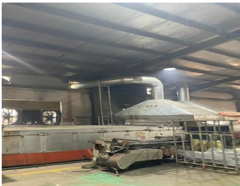
Hình 18. Hình ảnh công trình thu gom khí thải chuyên phủ nhựa
