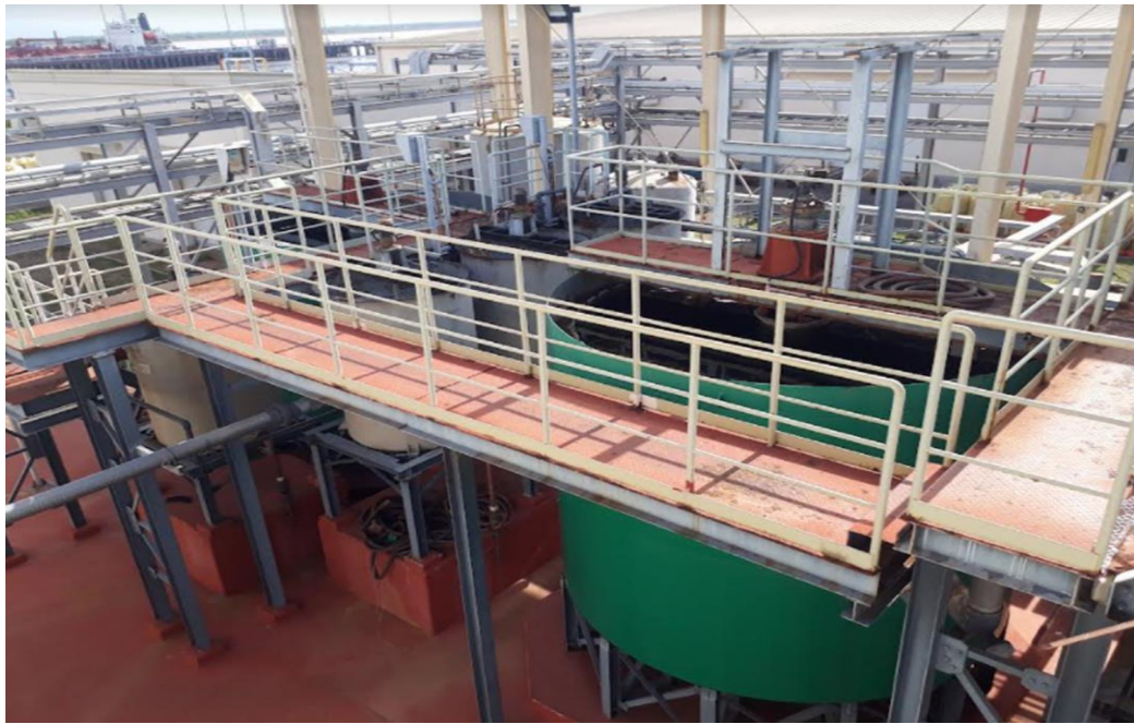
HTXL nước thải sản xuất, công suất 700 m 3 /ngày của nhà máy 1
