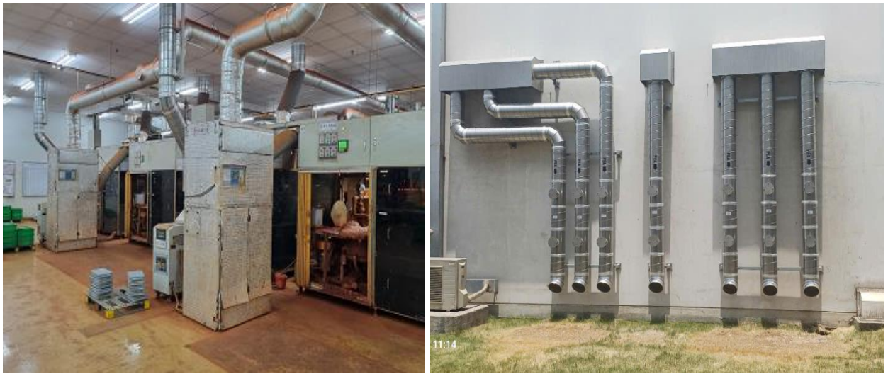
HTXL khí thải của nhà máy 4
