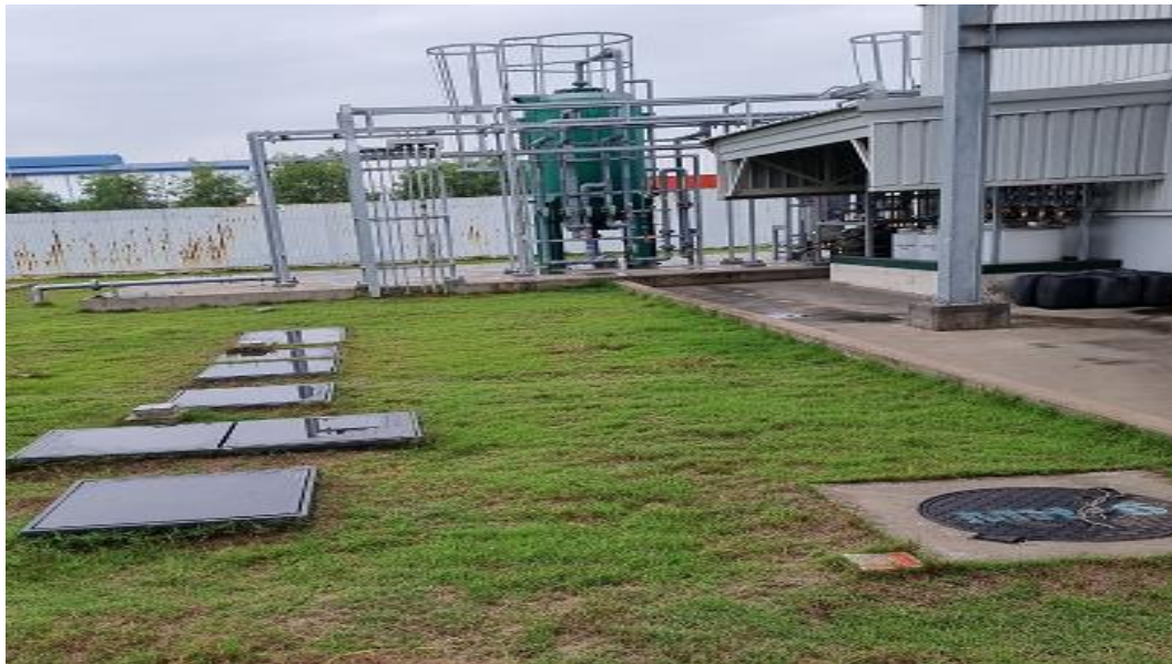
HTXL NTSH, công suất 13 m 3 /ngày đêm của nhà xưởng 3.2
