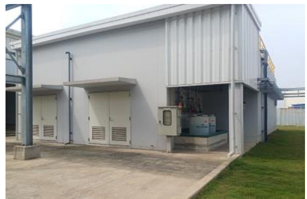
HTXL NTSH, công suất 120 m 3 /ngày đêm của nhà xưởng 4.2
