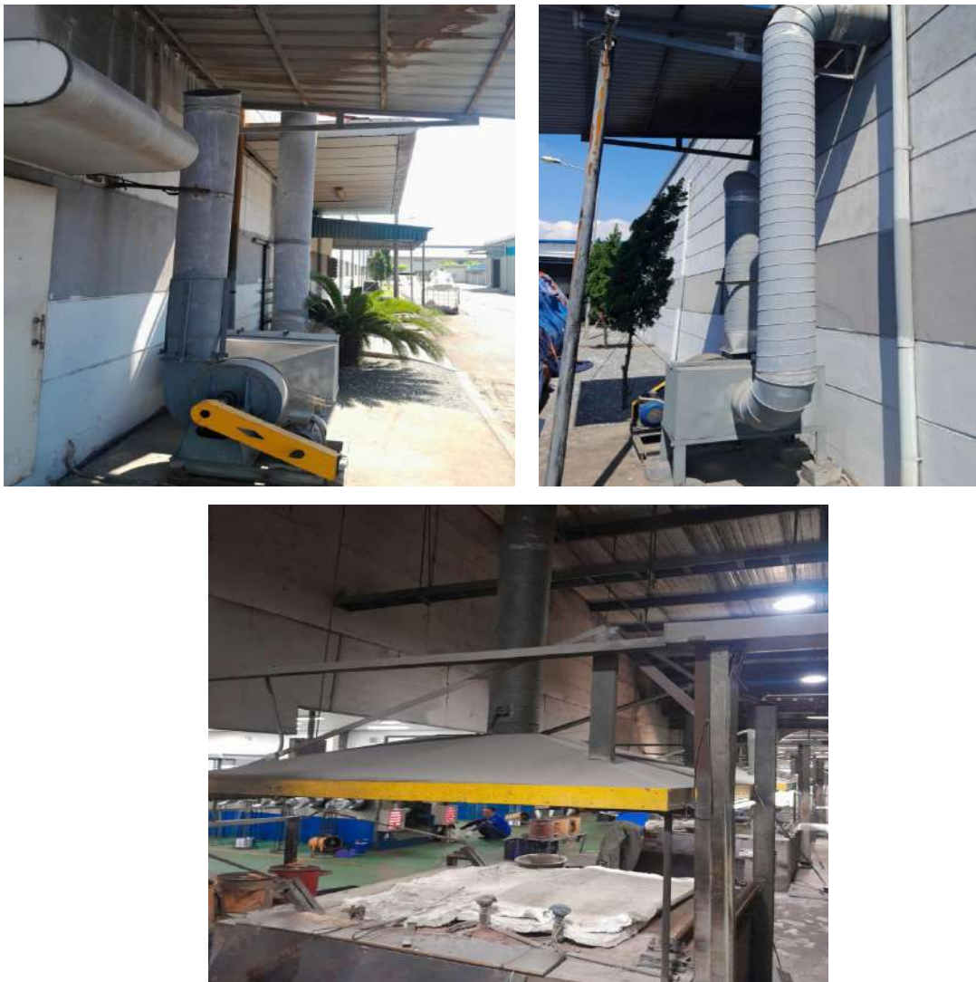
Hình 3.8. Hình ảnh hệ thống xử lý khí thải hiện trạng của nhà máy
