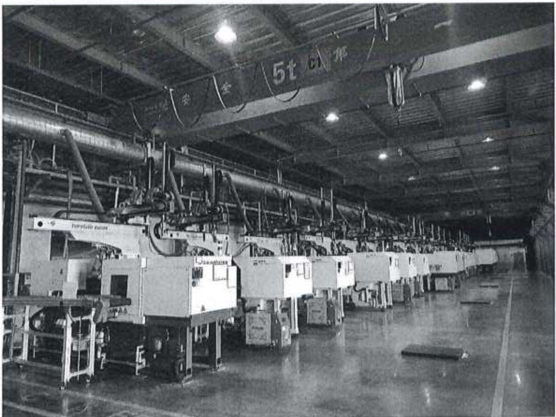
Hình 3.9. Hệ thống thu gom, xử lý hơi hữu cơ công đoạn ép nhựa (tầng 1)
