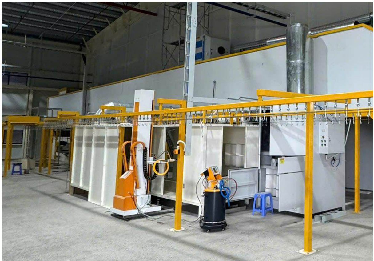
Hình 3.6. Hình ảnh hệ thống thu gom và xử lý bụi buồng sơn tĩnh điện
