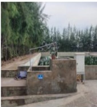
Bể khử trùng
