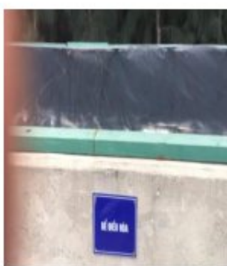
Bể điều hòa
