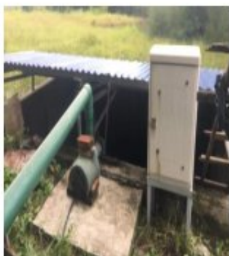
Bể thu gom
