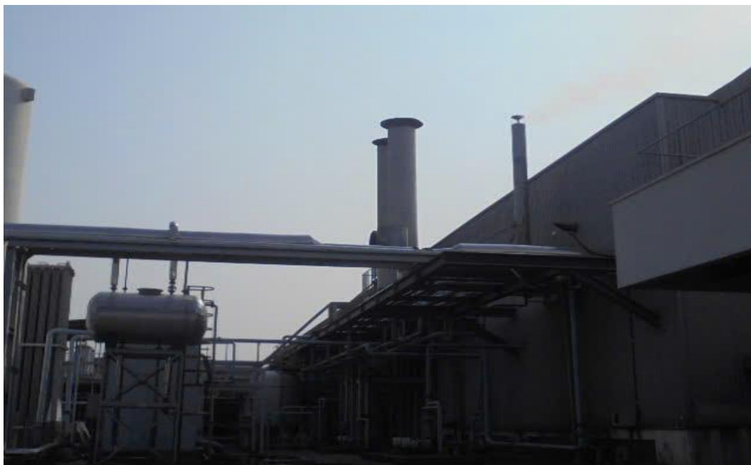
Hình 3. 18. Hình ảnh thực tế của hệ thống khí thải nồi hơi
