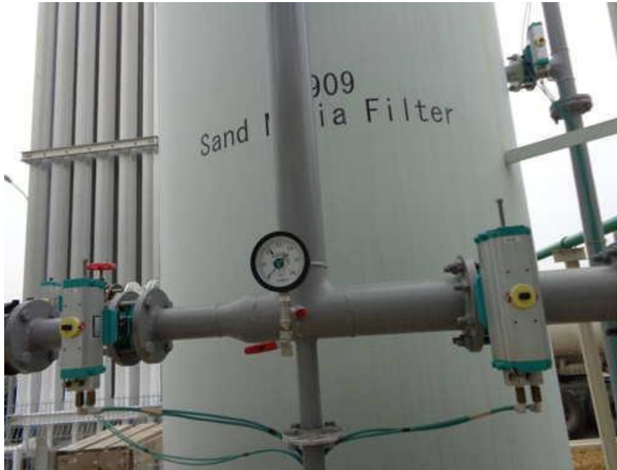
Hình 3. 14. Hình ảnh tank lọc cát
