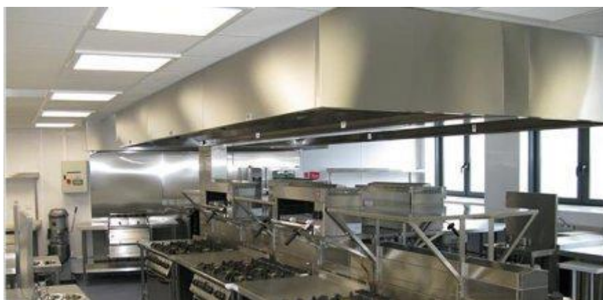
Hình 3. 25. Hệ thống chụp hút mùi nhà bếp
