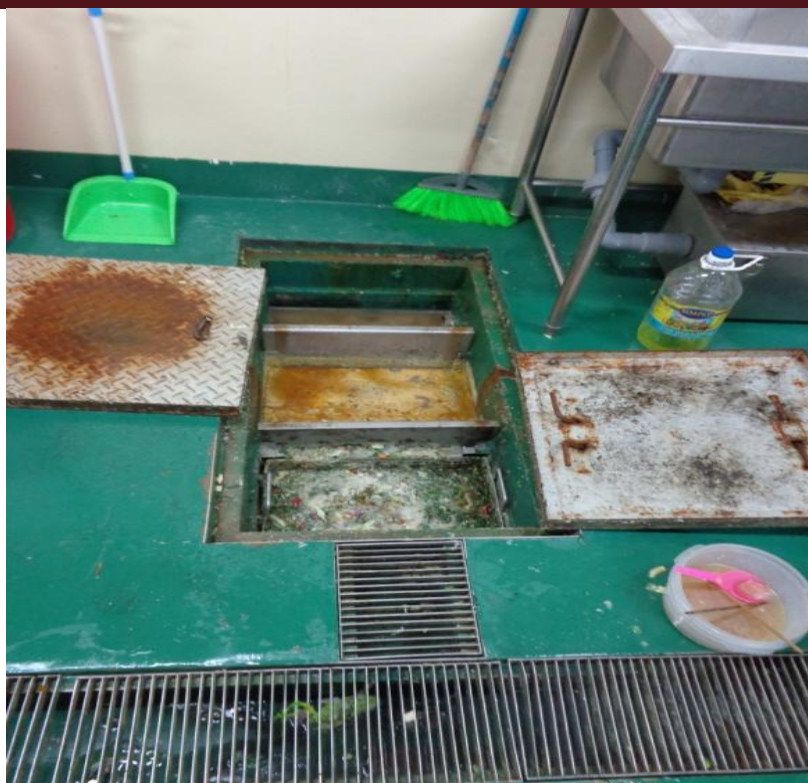
Hình 3. 4. Hình ảnh thực tế bể tách dầu mỡ nước thải nhà bếp hiện tại
