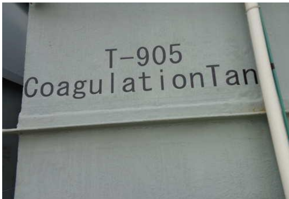
Hình 3. 11. Hình ảnh tank kết bông
