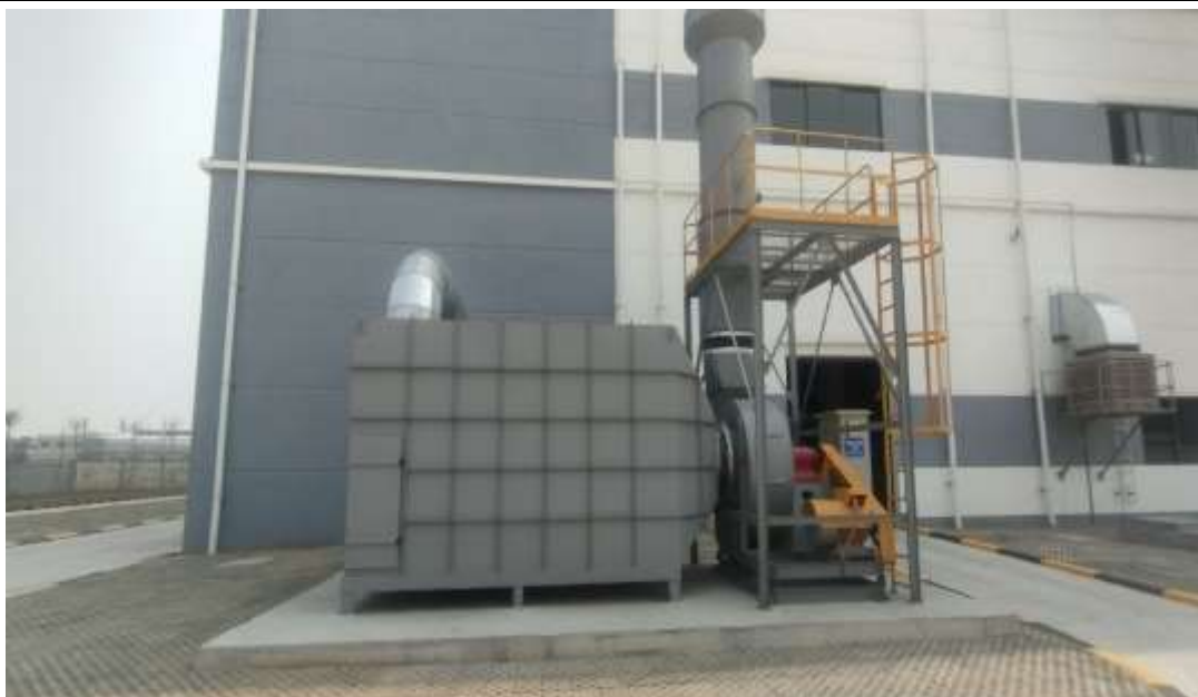
Hình 3.13. Hệ thống xử lý khí thải ép phun nhựa
