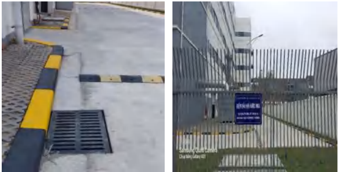
Hình 3. 3. Hình ảnh hệ thống thoát nước mưa dự án tại địa điểm 2
