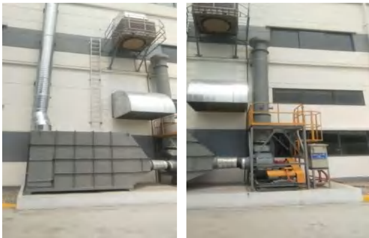
Hình 3. 14. Hệ thống xử lý khí thải xưởng điện tử SMT
