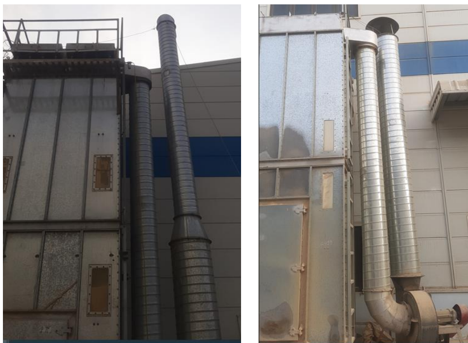
Hình 3.9. Hình ảnh ống khói hệ thống xử lý khí thải khu vực cắt cạnh, bào nhẵn
