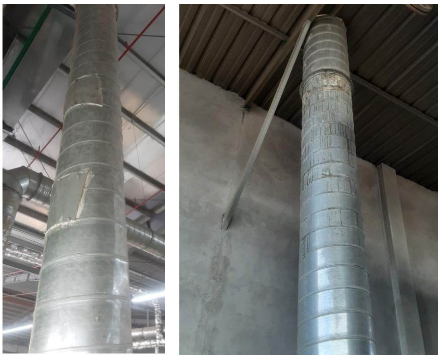
Hình 3.7. Hình ảnh ống khói khí thải hệ thống xử lý khí thải khu vực ép nóng xưởng 1 và xưởng 2
