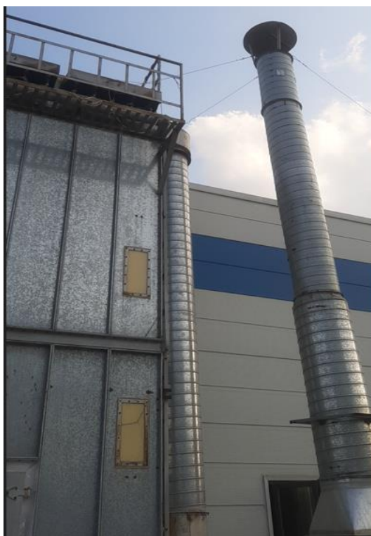
Hình 3.16. Ống thải khí hệ thống xử lý hơi sơn
