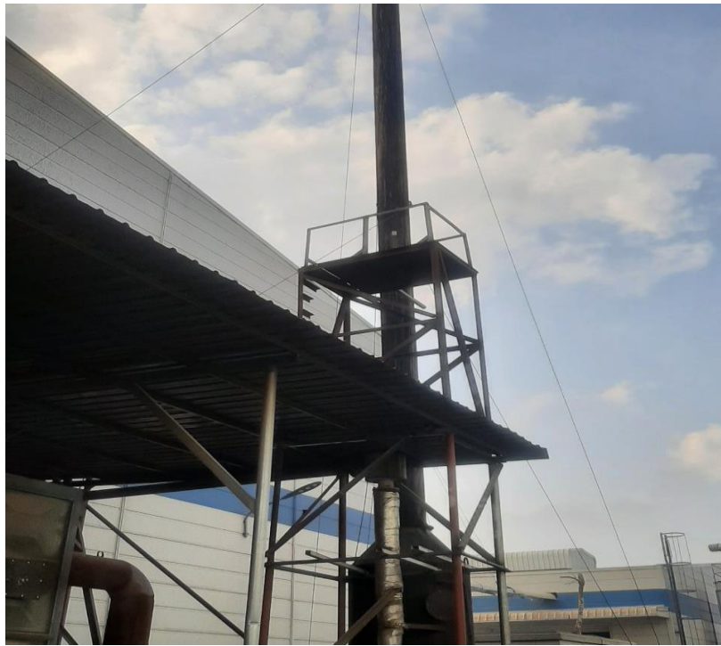
Hình 3.18. Hình ảnh ống khói khí thải khu vực nồi hơi
