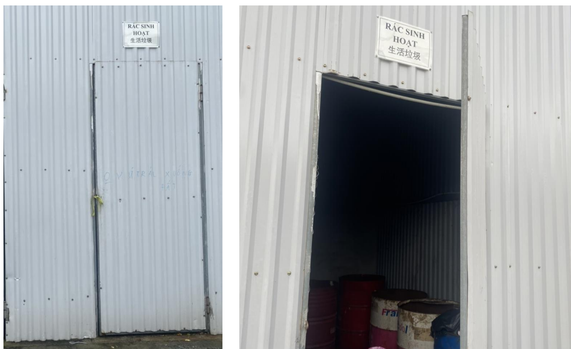
Hình 3.20. Kho chứa rác thải sinh hoạt của Nhà máy
