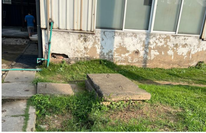
Hình ảnh hiện trạng ga thoát nước thải của Công ty Huazhong
