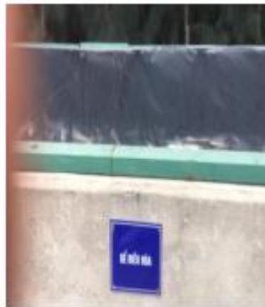
Bể điều hòa
