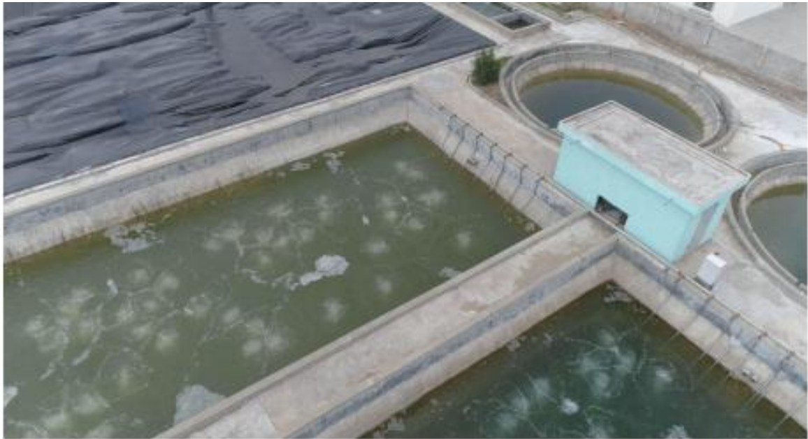
Hình ảnh tổng thể Trạm xử lý nước thải
