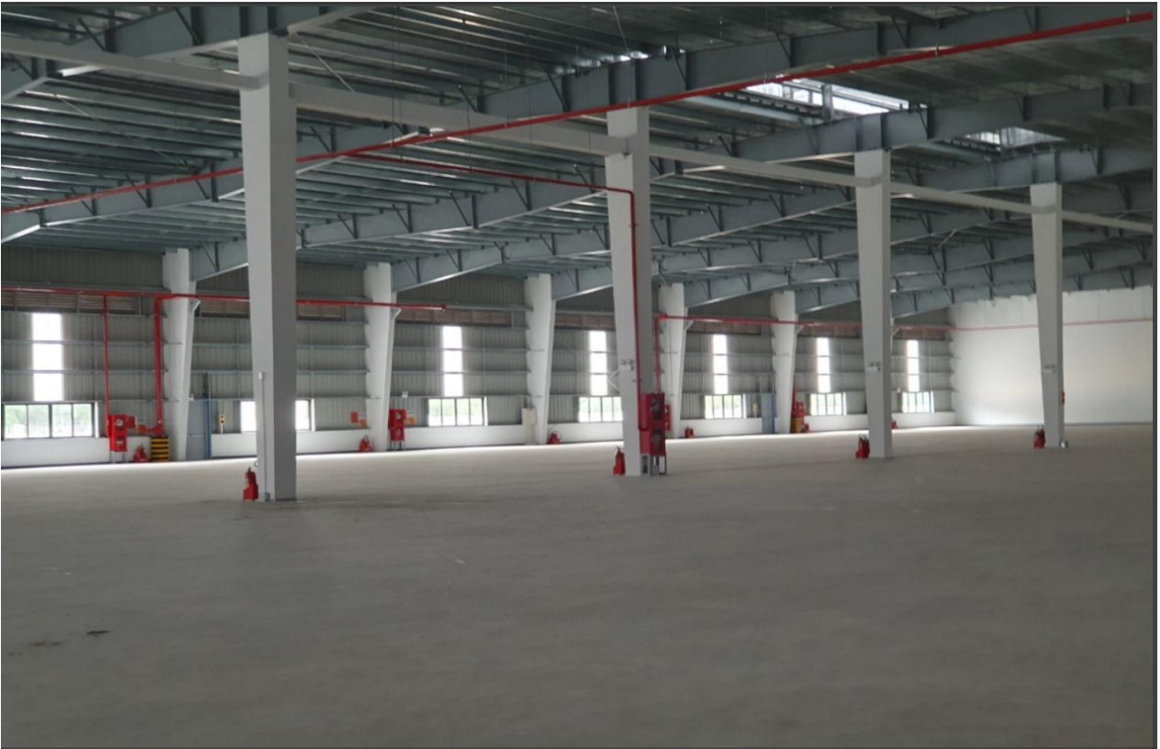
Thiết bị PCCC bên trong xưởng
