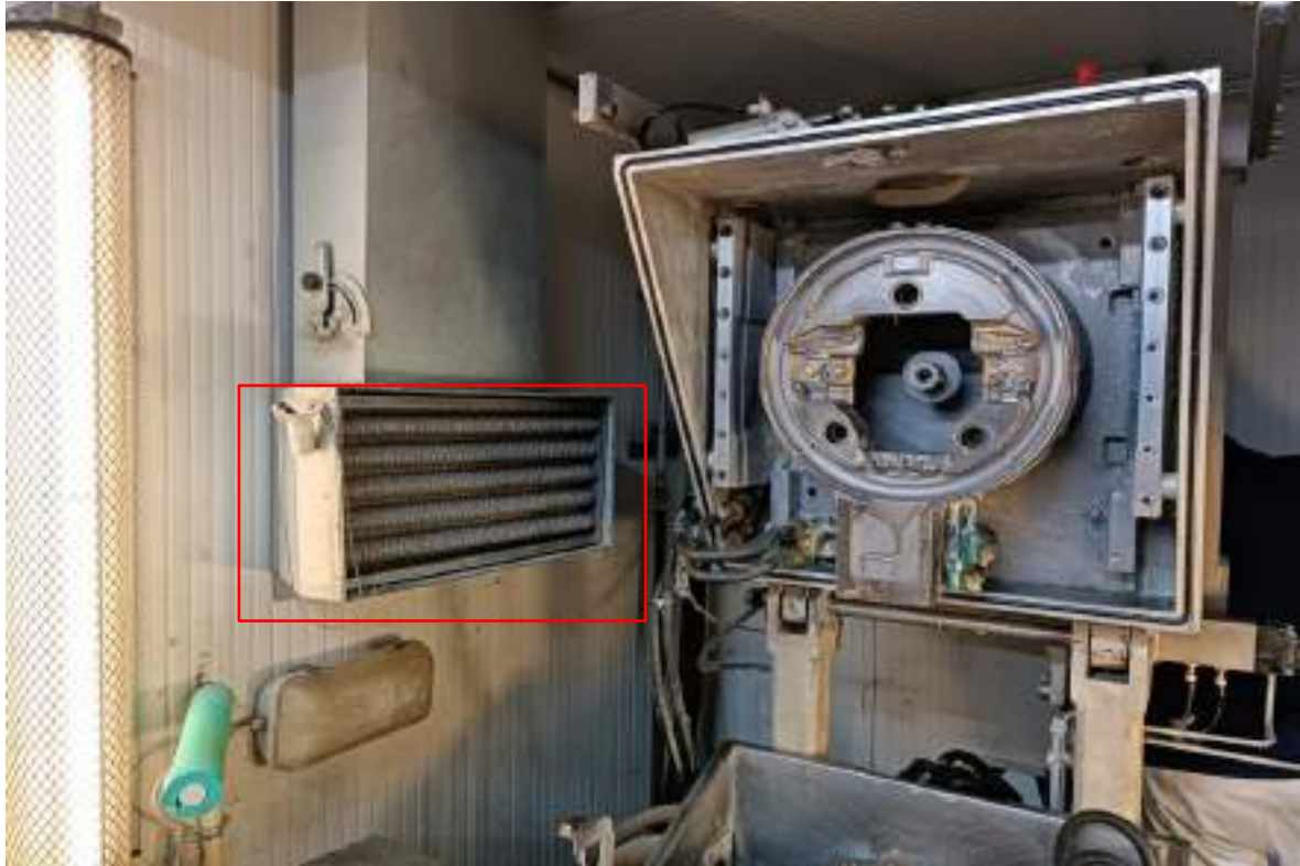
Hình 23. Hình ảnh tấm lọc ngăn dung môi bay hơi tại công đoạn Đúc PU
