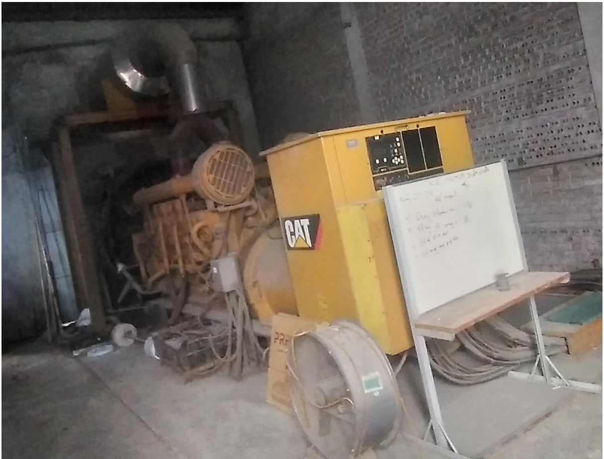
Hình 4.13. Máy phát điện dự phòng
