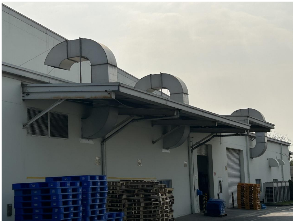
Hình 36. Ống phóng không khí đúc nhựa nhà xưởng 2
