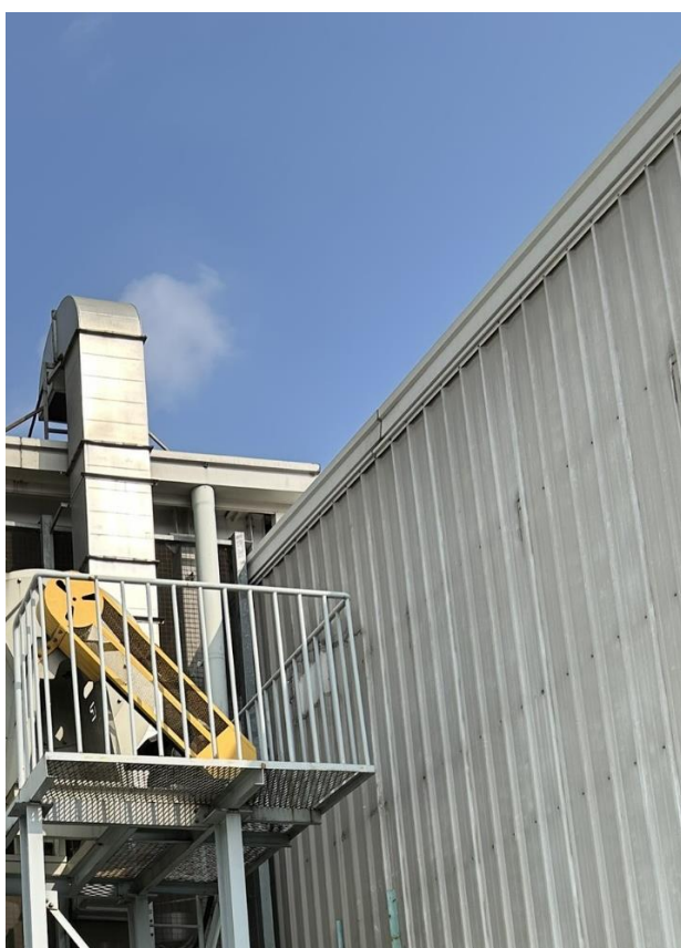
Hình 34. Ống phóng không xưởng 1
