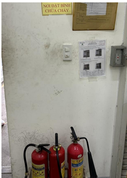
Hình 16. Bình chữa cháy trước kho chứa hoá chất
