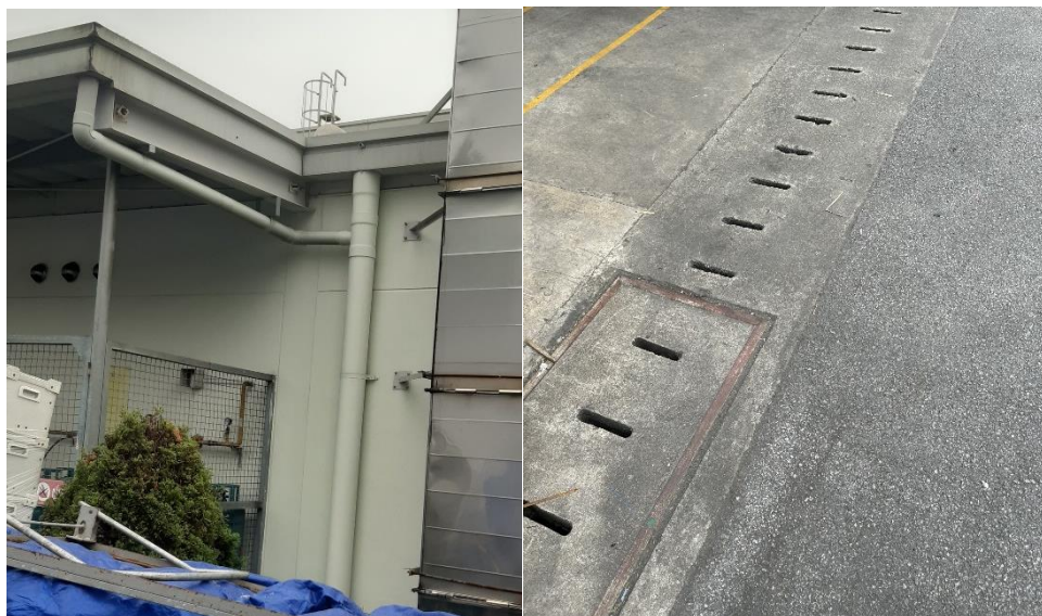
Hình 23. Ống thu nước mưa trên mái và rãnh thu nước mưa tràn mặt
