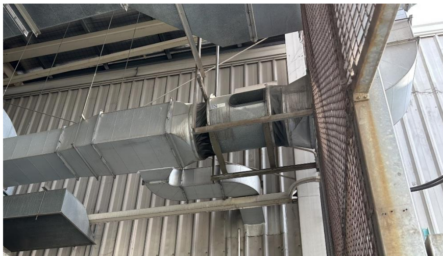
Hình 33. Quạt hút khí sản xuất nhà xưởng 1
