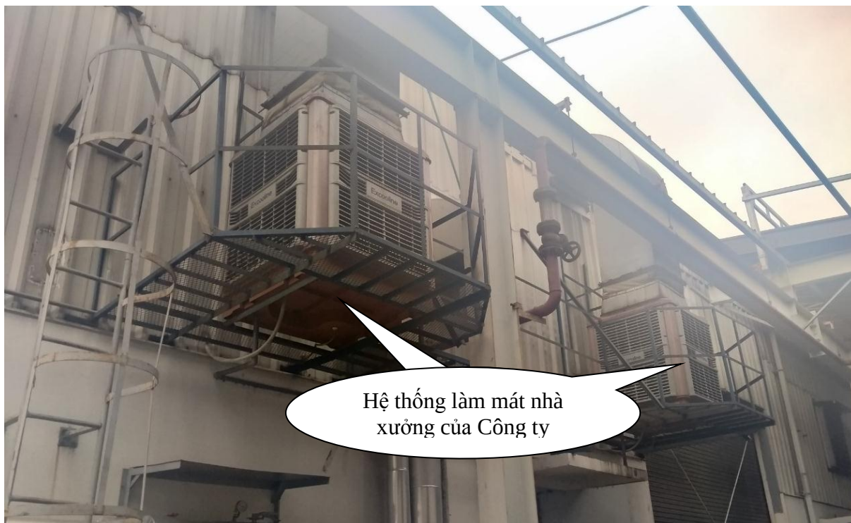
Hình 3.13. Hệ thống làm mát nhà xưởng của Công ty
