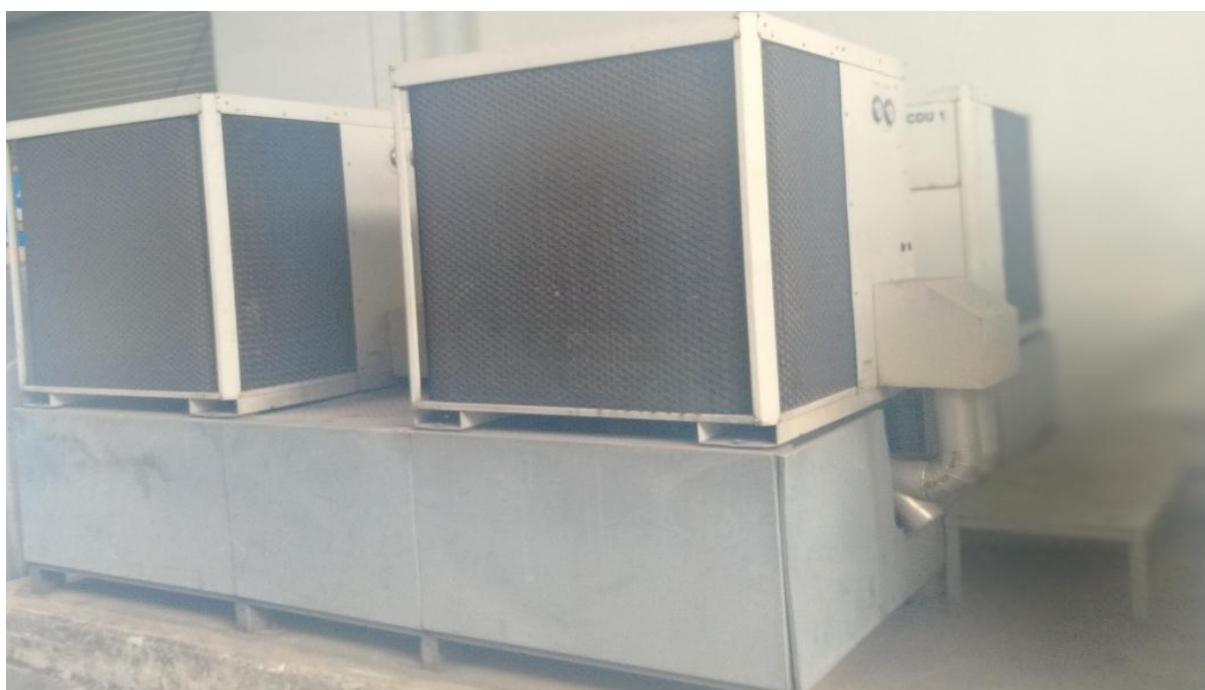
Hình 3.11. Hình ảnh hệ thống giải nhiệt của xưởng ép phun số 02
