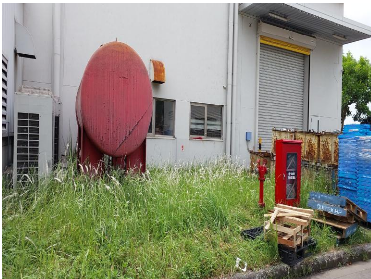
Hình 3.13. Hệ thống PCCC của Công ty
