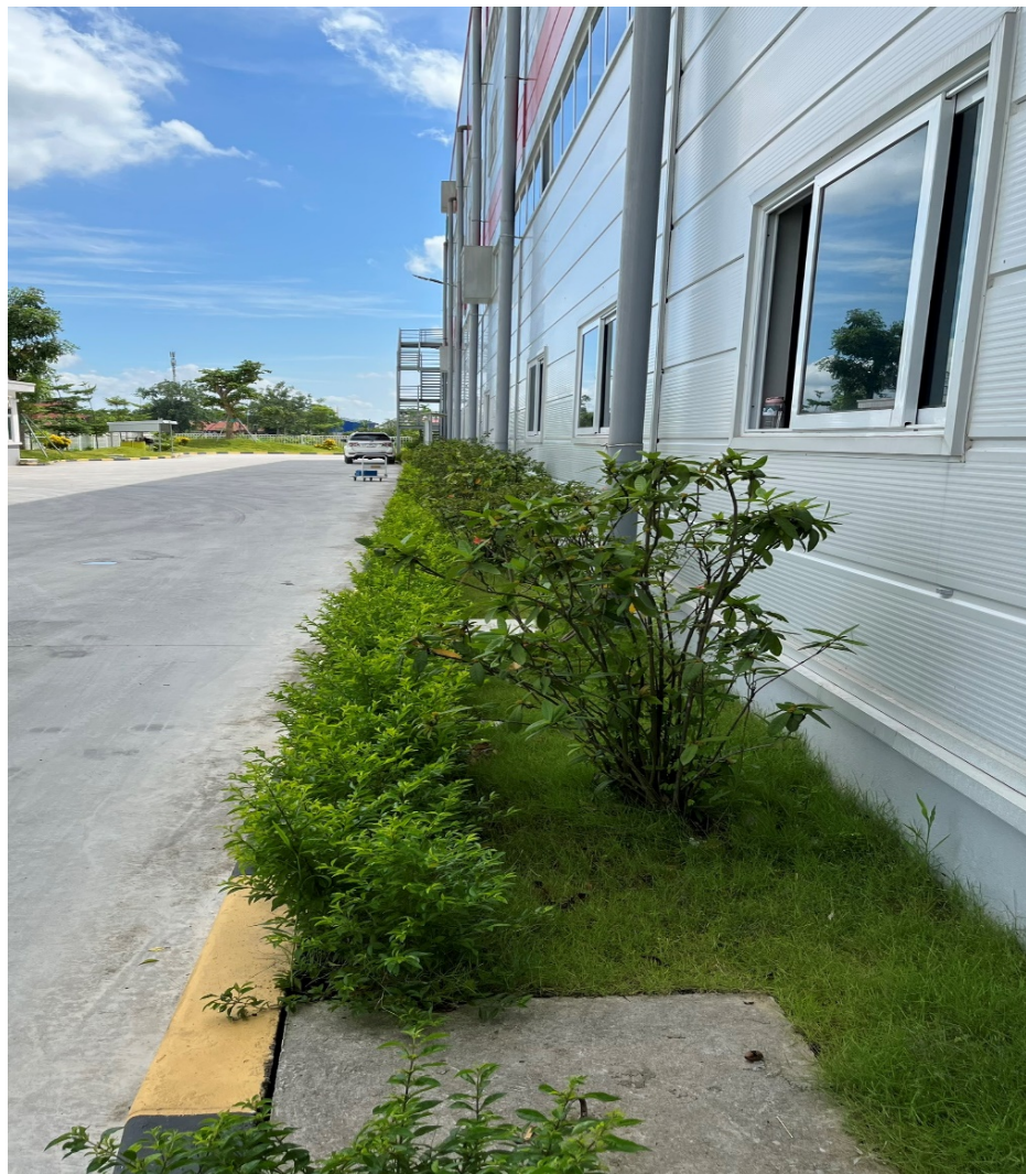
Hình 13. Hình ảnh hệ thống thu gom, thoát nước mưa của nhà máy
