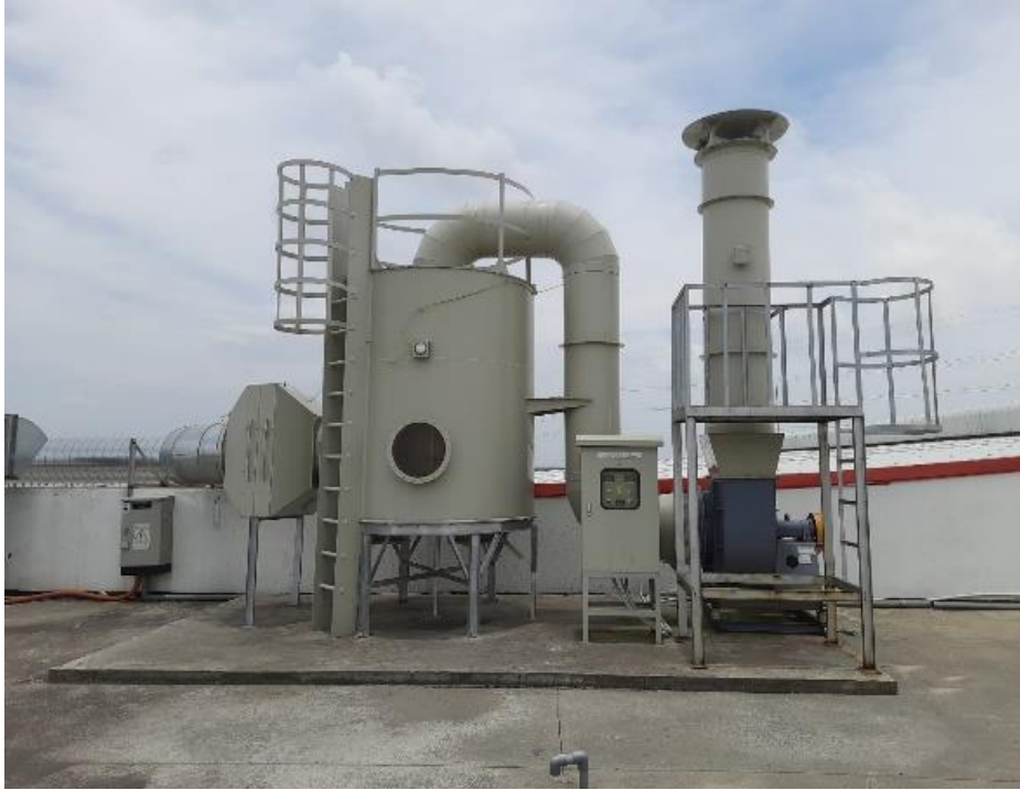
Hình 3. 8. Hệ thống xử lý khí thải khu vực ép nhựa
