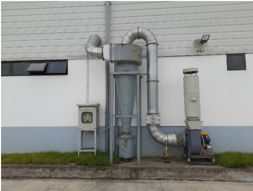
Hình 3. 10. Hệ thống xử lý bụi khu vực nghiền nhựa
