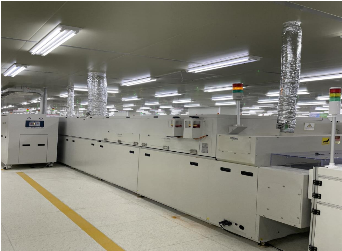
Máy hàn đối lưu tại tầng 1 xưởng 1 với 3 ống thu gom khí thải/máy
