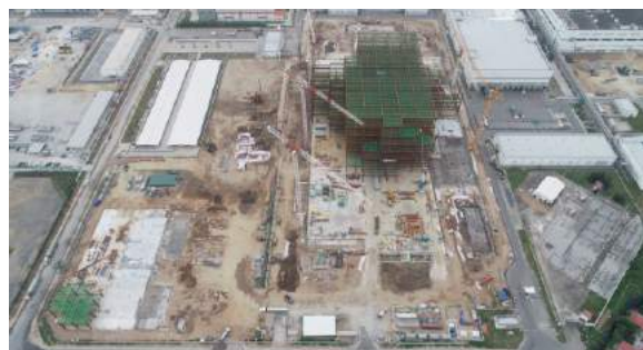
Công trường thi công tại nhà máy LG Display tại KCN Tràng Duệ
