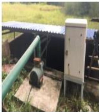
Bể thu gom
