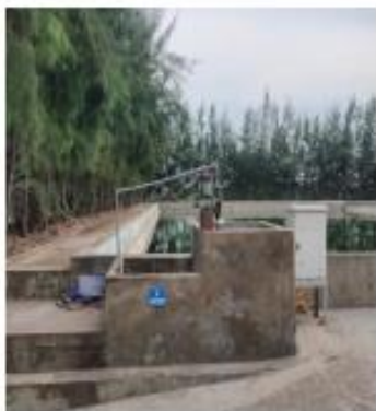
Bể khử trùng
