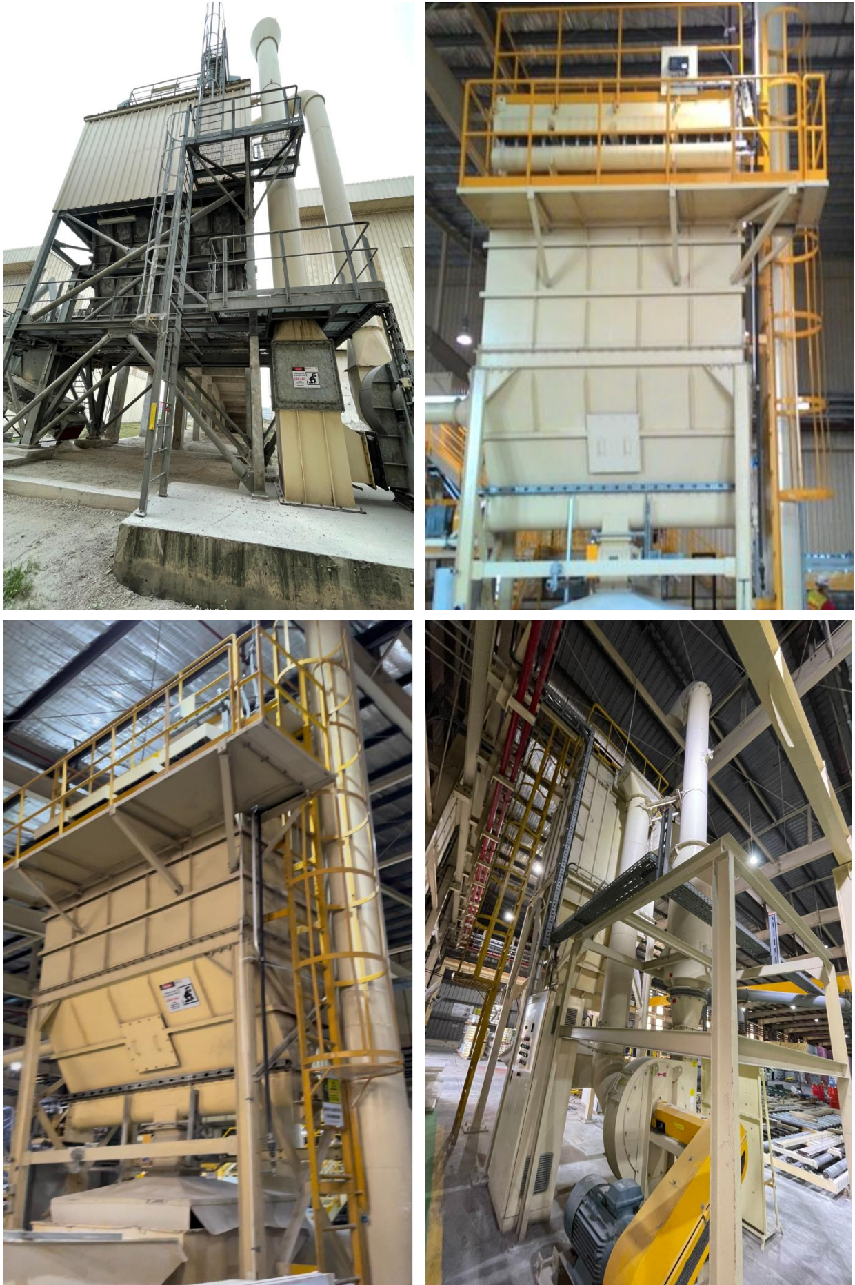
Hình 3.12. Hình ảnh một số hệ thống xử lý bụi, khí thải
