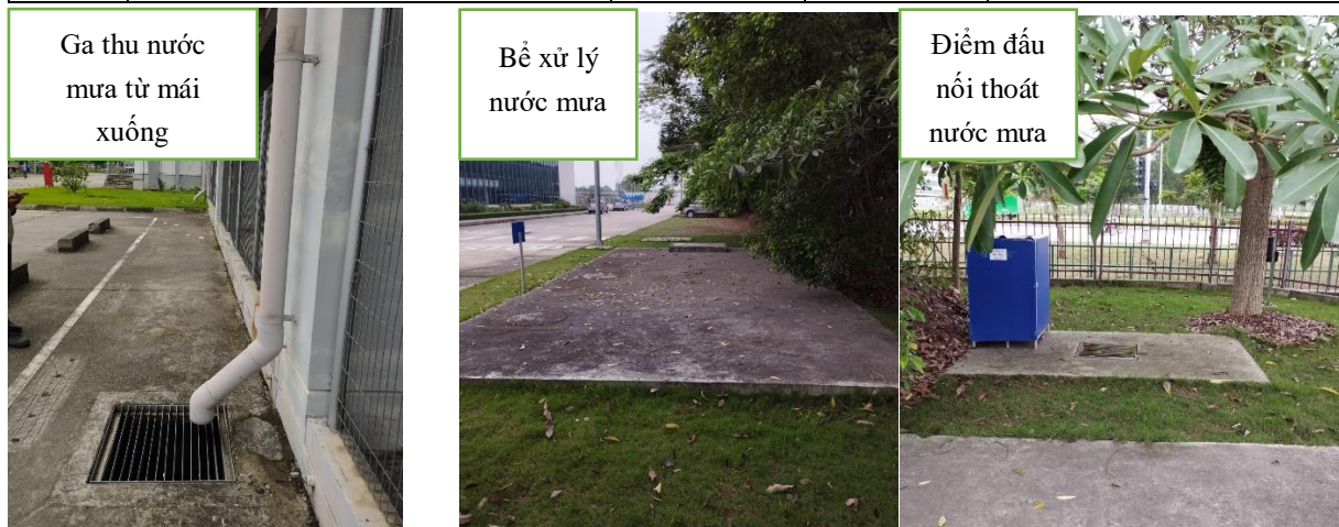
Hình 4. 10. Một số hình ảnh về công trình thu gom, xử lý, thoát nước mưa
