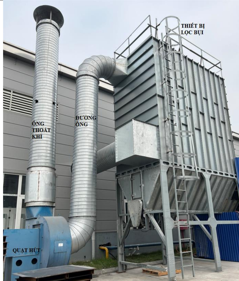
Hình 3.5. Hệ thống thu gom, xử lý bụi từ máy cắt tấm, tạo hèm (máy làm chốt)
