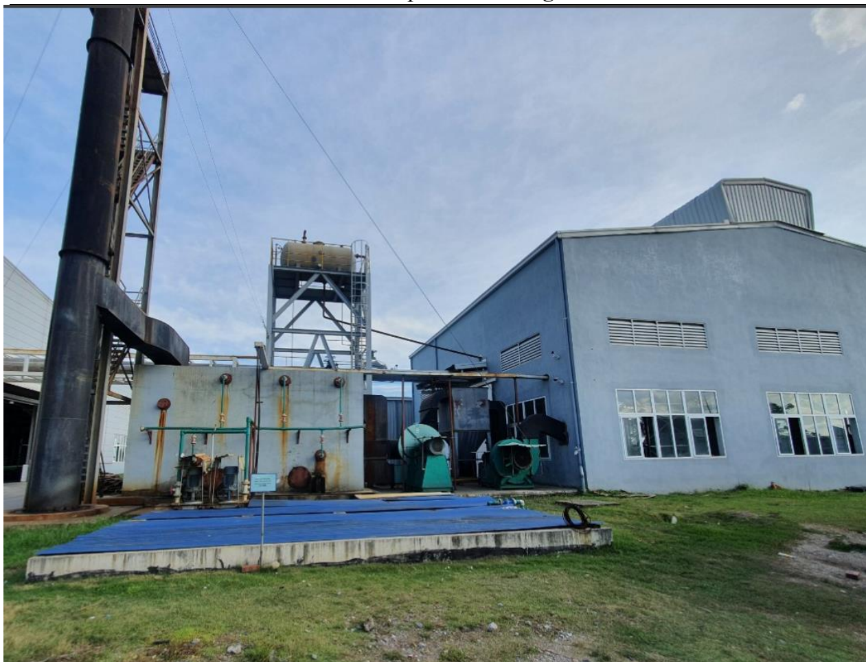
Hình 3.14. Hệ thống thu gom xử lý bụi, khí thải từ nồi gia nhiệt dầu đốt than
