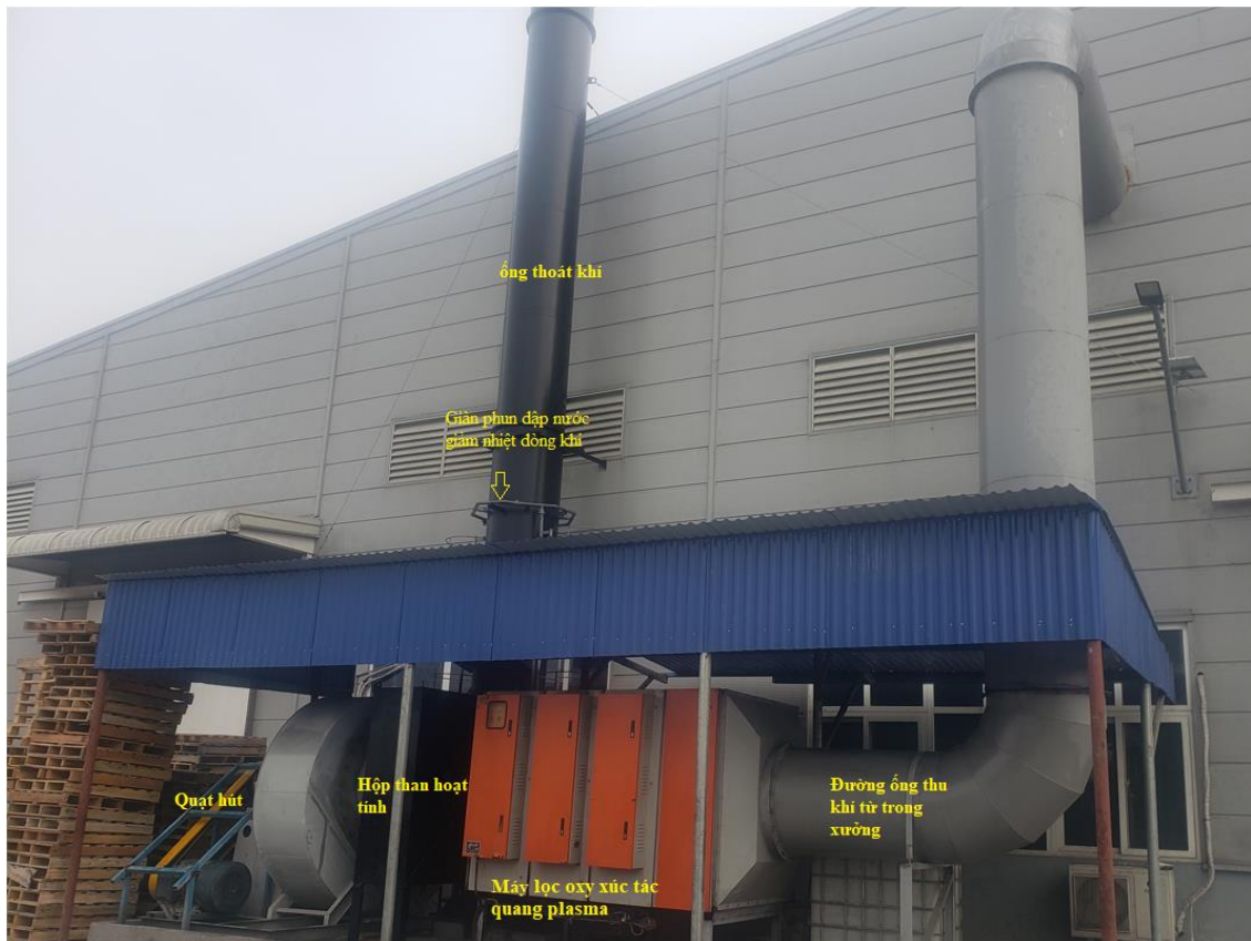
Hình 3.11. Hệ thống thu gom, xử lý khí thải từ dây chuyền sản xuất màng mỏng PVC
