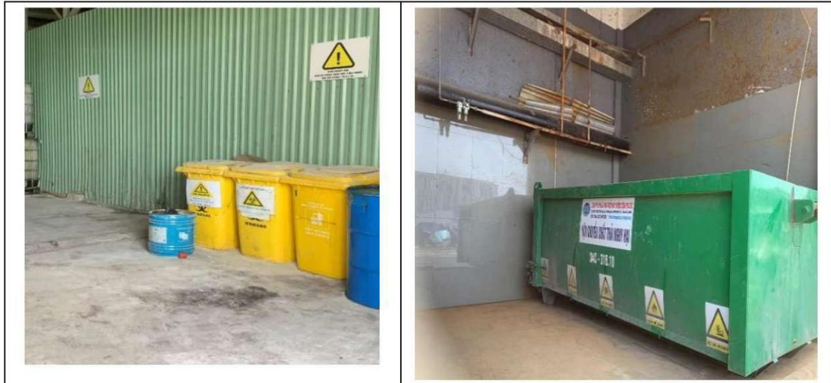
Hình 3. 15. Kho CTNH của Nhà máy
