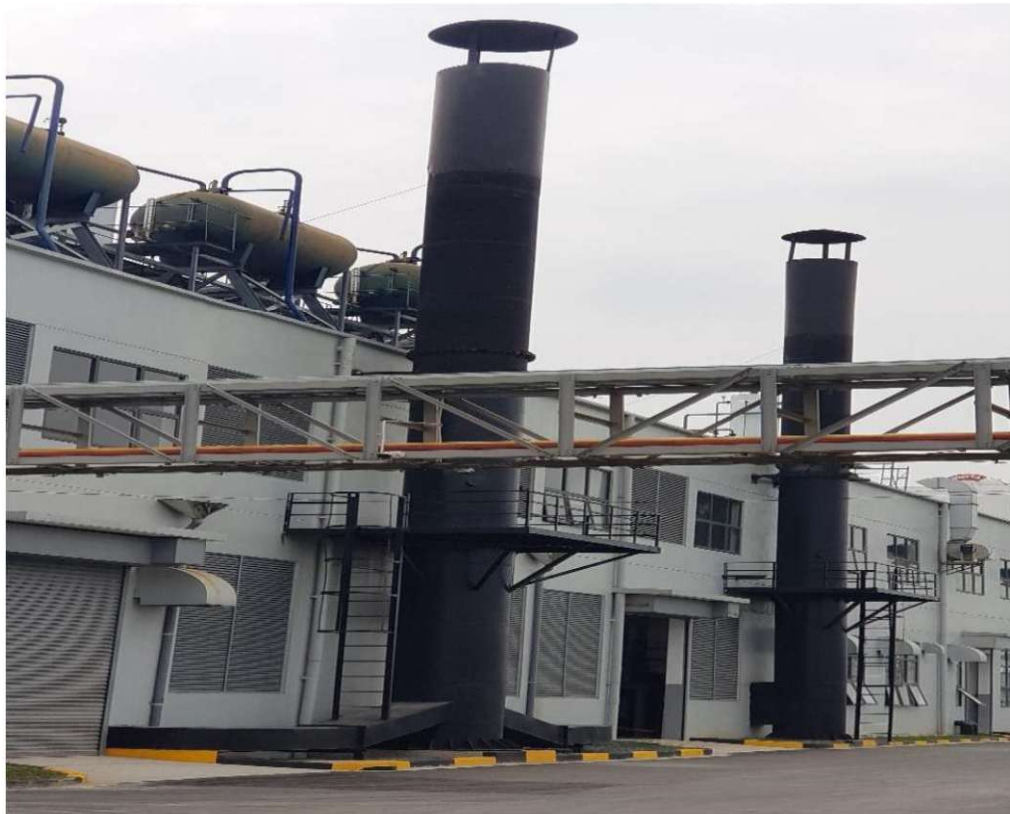
Hình 3.10. Hệ thống ống khói của hệ thống lò dầu và lò hơi
